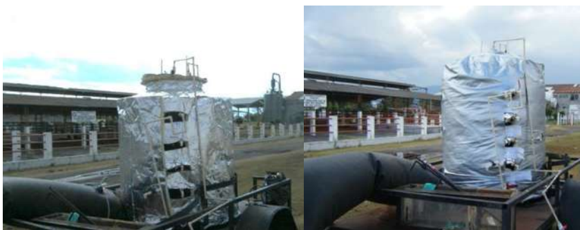
Figura 4. Aislado del Reactor UASB
