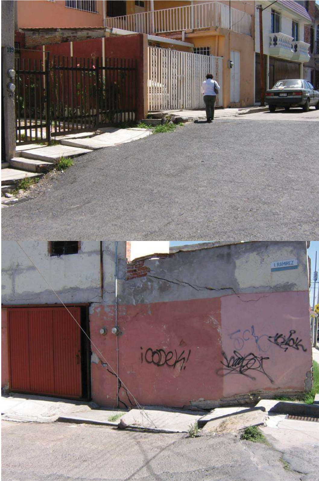
Figura 24. Daños ocasionados por la falla Poniente.
