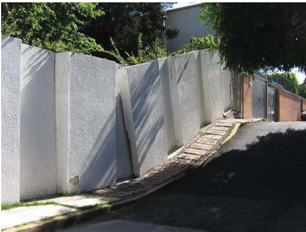
Figura 25a. Daños ocasionados por la falla Oriente.
