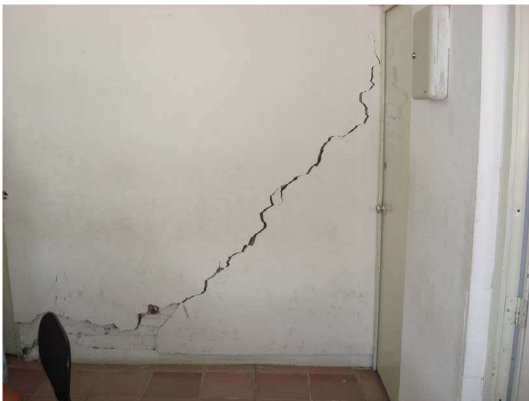
Figura 27. Daños ocasionados por la falla Insurgentes.
