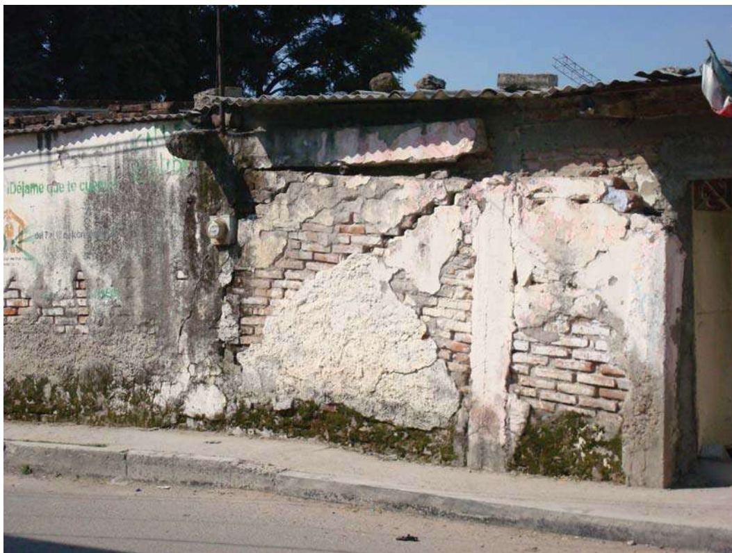
Figura 28a. Daños ocasionados por la falla Santa Teresita.
