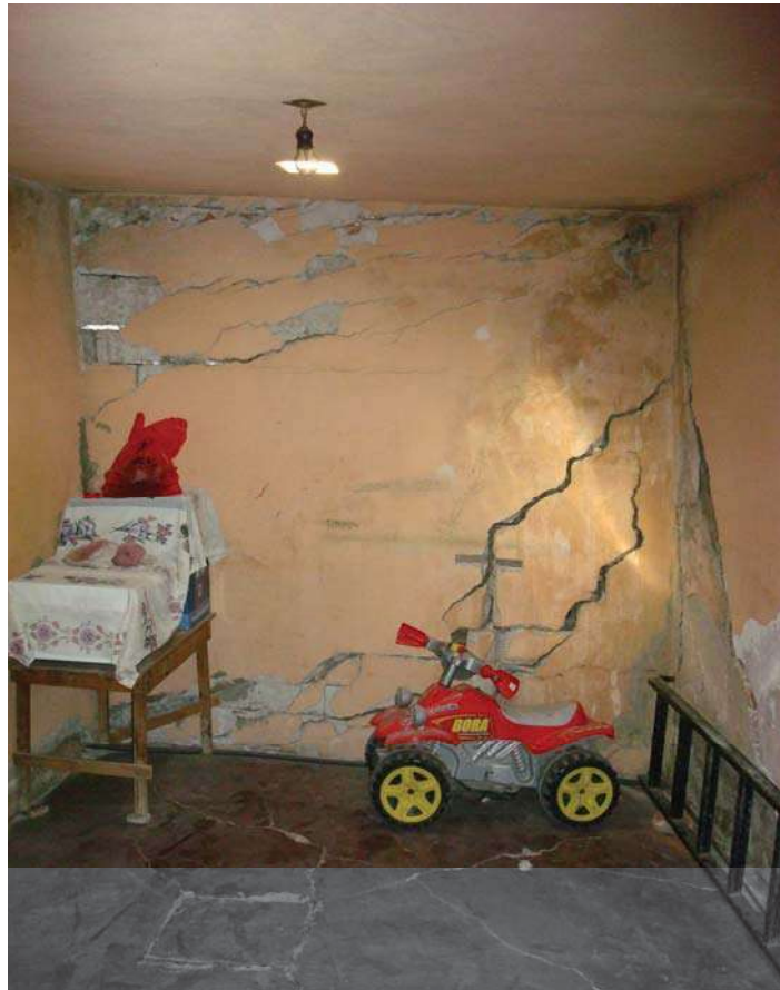
Figura 28b. Daños ocasionados por la falla Santa Teresita.
