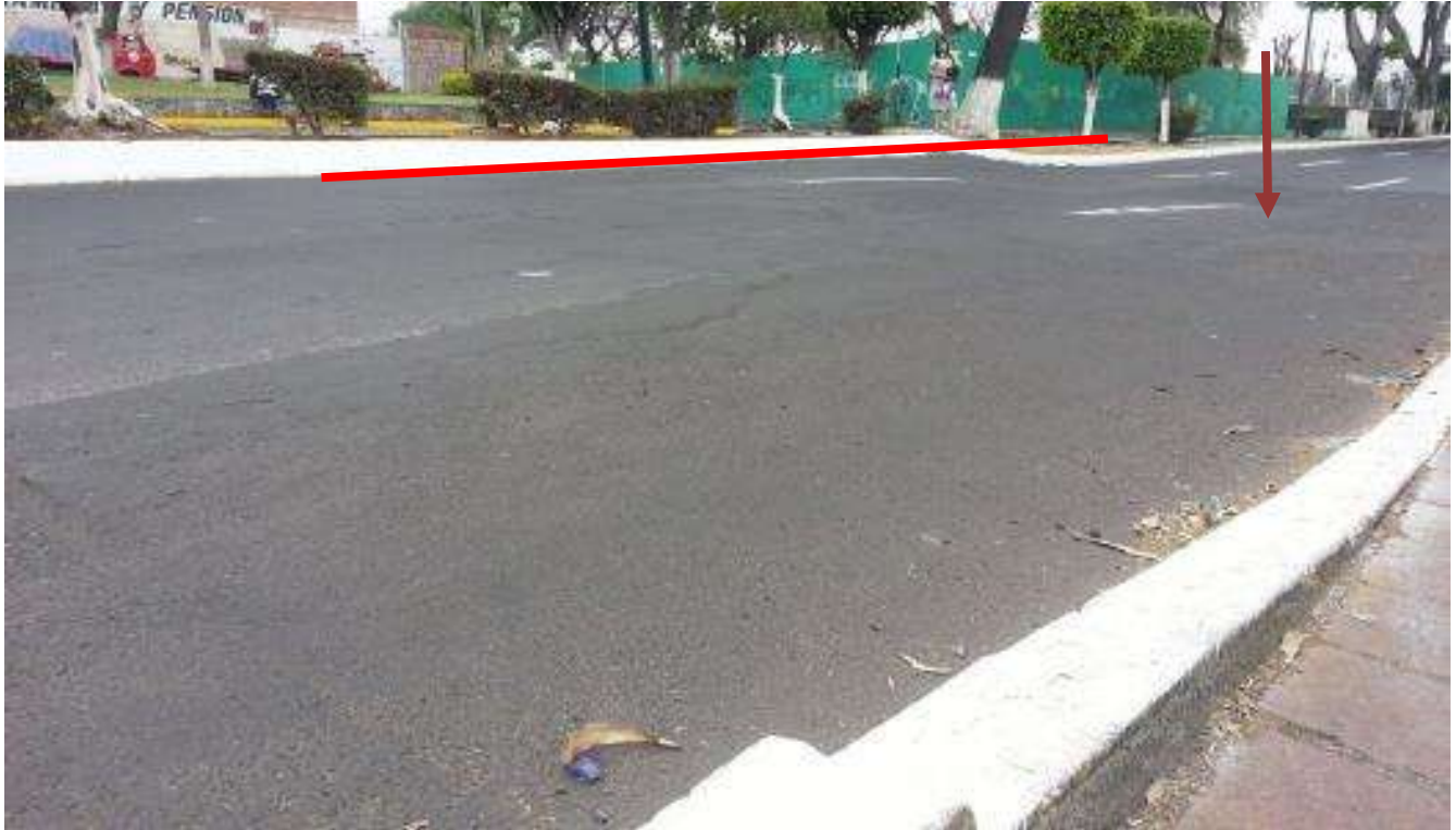
Figura 45: Vialidad deformada por falla geológica Nocupétaro.
