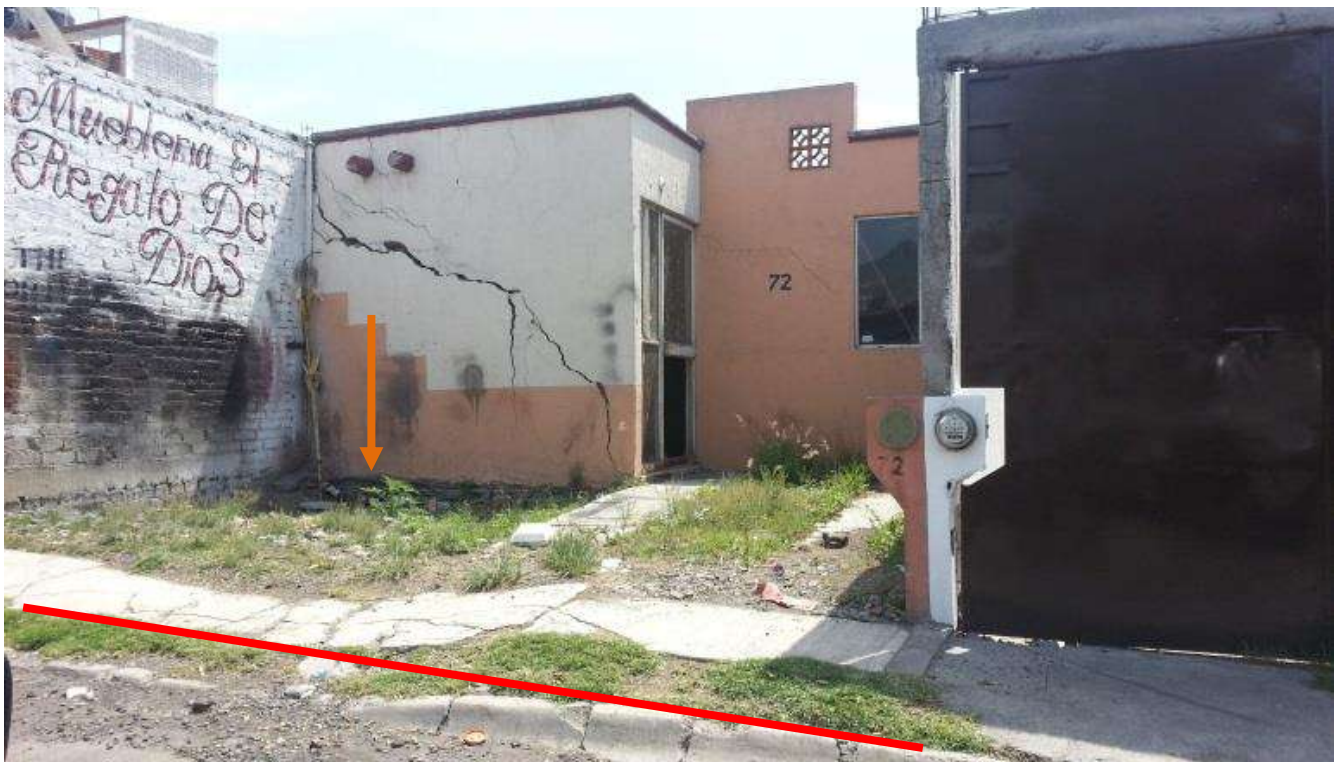
Figura 46: Daño a viviendas causado por falla geológica fraccionamiento Galaxias Tarímbaro.
