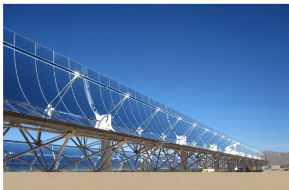
(d) Seguidor Parabólico
