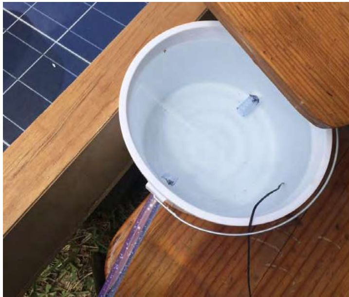
Figura 5.6. Termopar instalado en el tanque de almacenamiento.
