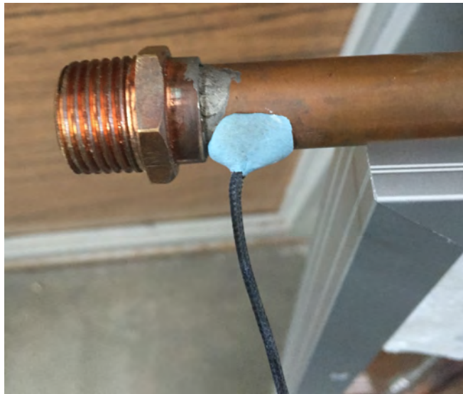
Figura 5.5. Termopar instalado en el tubo de salida del colector.
