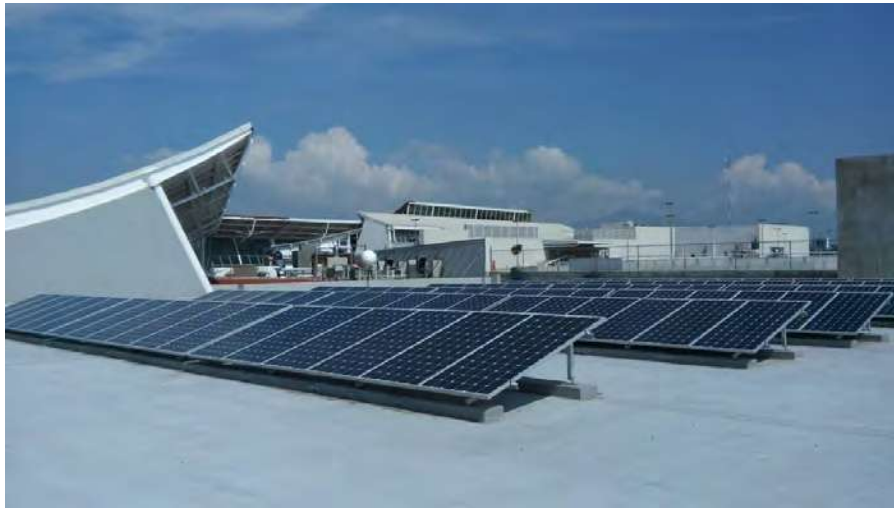
Figura 22. Sistema fotovoltaico instalado en el centro comercial.
