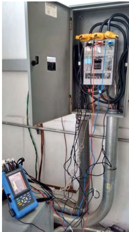
Figura 56. Medición en el sistema fotovoltaico.
