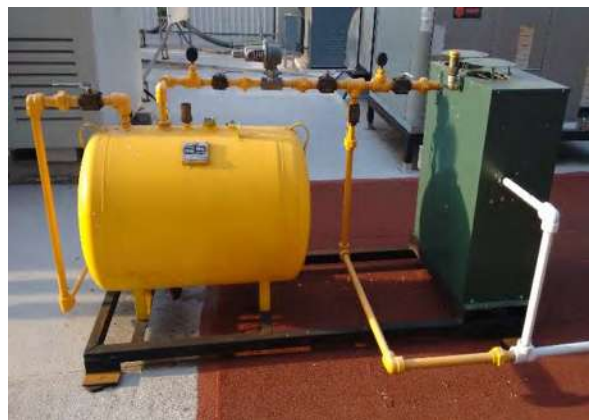
Figura 30. Tanque de combustible auxiliar con calentador de gas.
