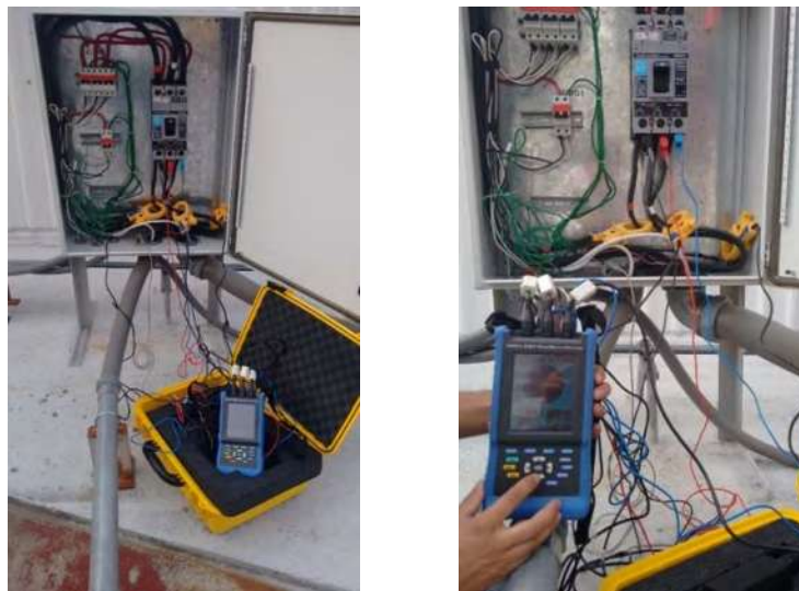
Figura 52. Medición en microturbina
