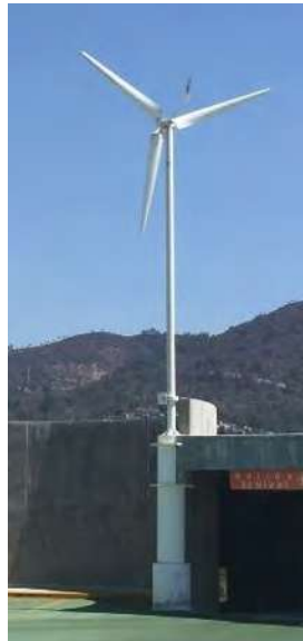
Figura 24. Aerogenerador de eje horizontal Aeolos-H 3 kW.
