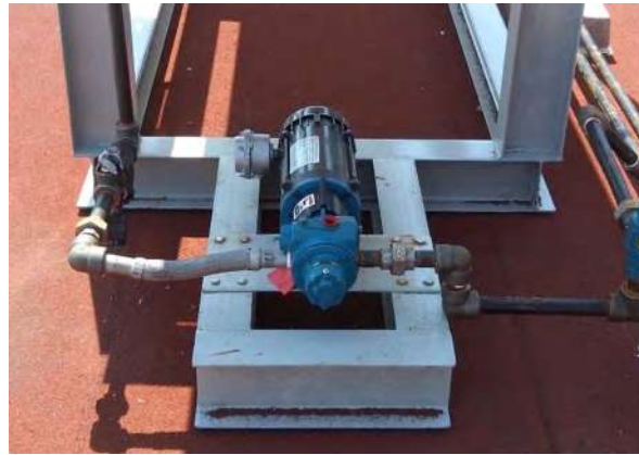
Figura 29. Bomba de condensados.
