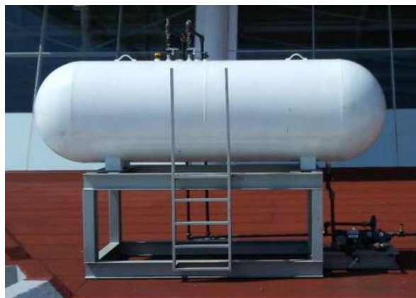
Figura 28. Tanque de combustible principal.
