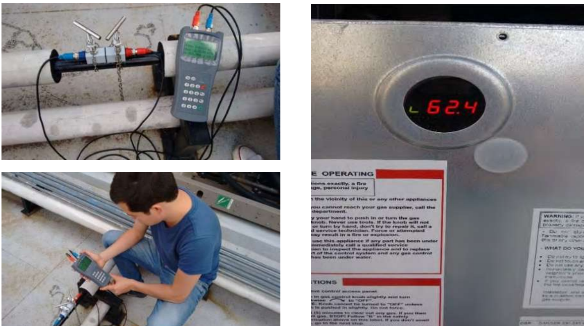
Figura 54. Medición en los enfriadores (flujo másico del agua de alimentación).
