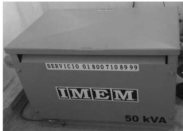
Figura 31. Transformador tipo seco 220/440 V.
