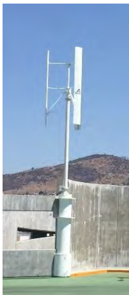
Figura 25. Aerogenerador de eje vertical Aeolos-V 3 kW.
