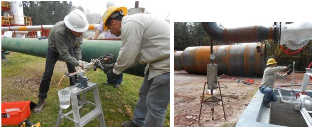
Fotografías E Toma de muestra de gas en la válvula acondicionada para tal propósito. A la derecha: Instalación de separador portátil directamente al cabezal.
