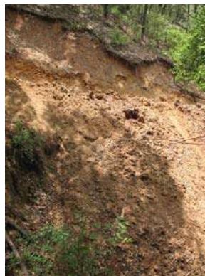
Figura 38. Desgajamiento de cerros provocados por la construcción de caminos para la extracción de madera.
