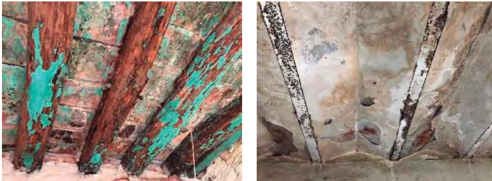
Fig. 91. Patologías registradas en diferentes sistemas de cubierta. Fotografía tomada por la autora [09/11/2020]
