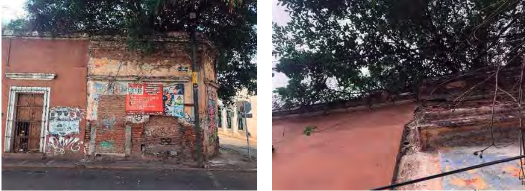
Fig. 89. Fotografías de alteraciones y deterioros mostrados en fachada. Fotografía tomada por la autora [31/08/2020]
