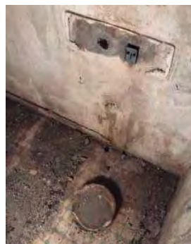
Fig. 82 Instalación sanitaria fuera de servicio dentro del inmueble. Fotografía tomada por la autora [09/11/2020]
