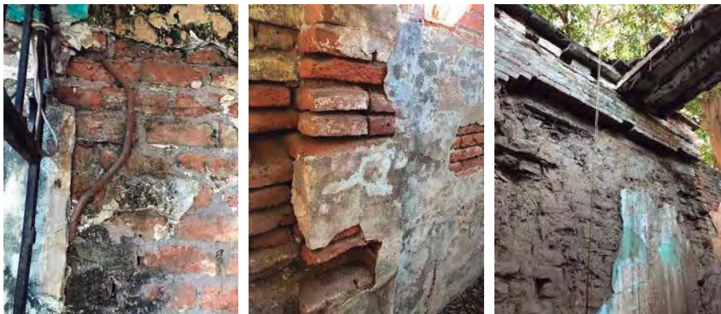
Fig. 92. Daños en muros. Fotografía tomada por la autora [09/11/2020]
