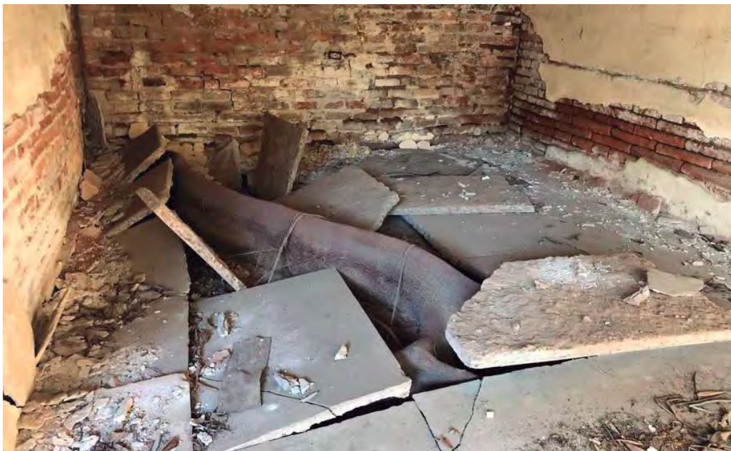
Fig. 48. Fotografía interior del inmueble con grave destrucción a causa de la invasión de flora. Fotografía por la autora [21/10/2020].
