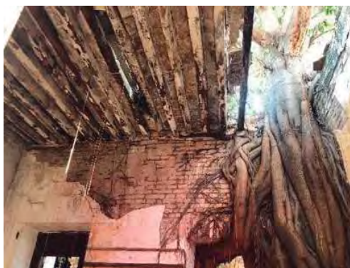
Fig. 20. Inmueble en abandono ubicado en la calle Miguel Hidalgo esquina con Jesús Andrade. Se aprecian los muros de ladrillo y la cubierta con vigas de madera. Fotografía tomada por la autora. [21/10/2020]
