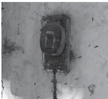
Fig. 79 Apagador fuera de servicio al interior del inmueble. Fotografía tomada por la autora [09/11/2020]
