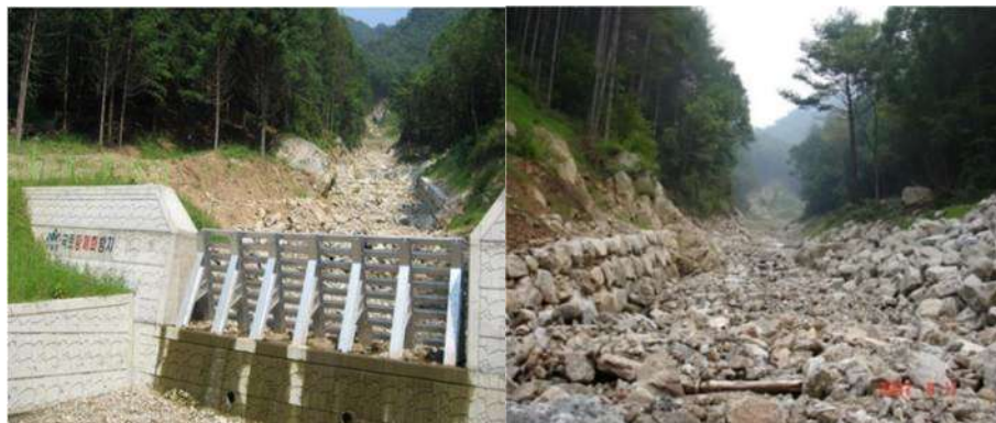
Figura 11. Vistas panorámicas del sitio de monitoreo de deslizamientos de tierra después de la construcción de las barreras de escombros.
