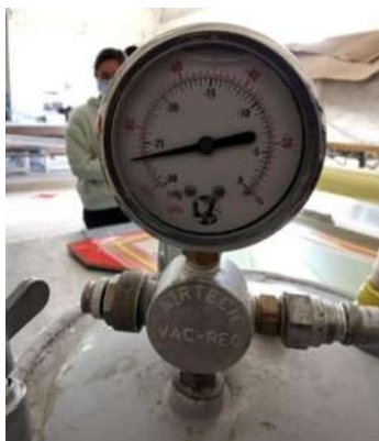
Figura 3 14 Control del manómetro
