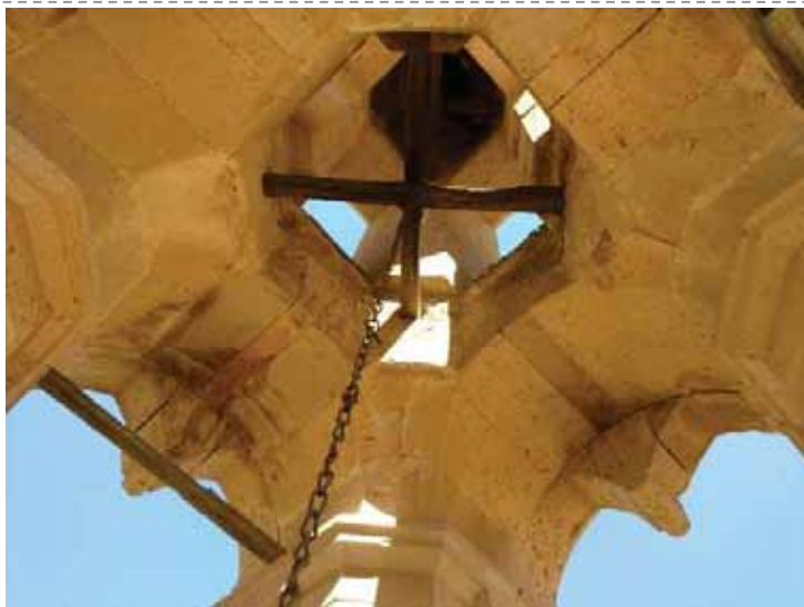
Imagen 7: vigas de madera para soporte de campana.
