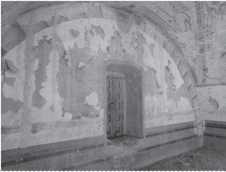
Imagen 1: ventana coral, con capialzado en arco y jambas en derrame. Se observa el papel tapiz desprendido del muro.
