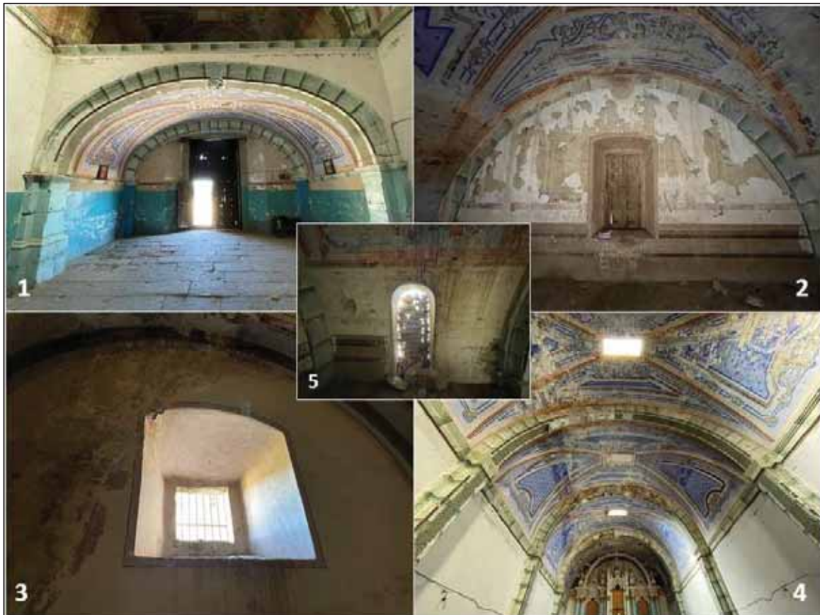
Figura 7: Vanos existentes en los espacios del inmueble. Sotocoro (1), coro (2), sacristía (3), nave (cenital) (4), y antiguo vano de acceso en muro sur del coro (5). Fuente: Fotografías del autor.
