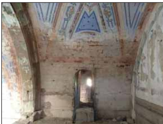
Figura 26: Intradós de la cubierta del templo. Vista desde el coro. Fuente: Fotografía del autor.
