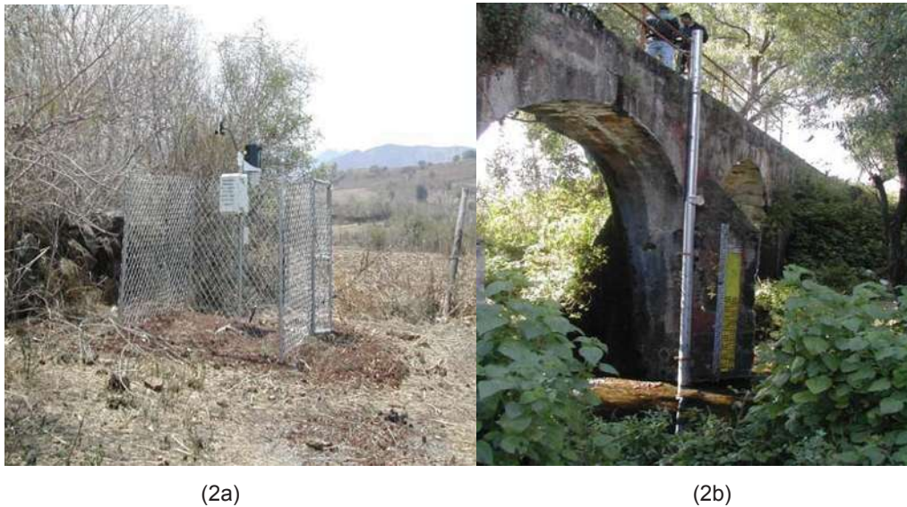
Figura 2 Estructuras tipo para estaciones meteorológicas (2a) y de medición del nivel de agua (2b).
