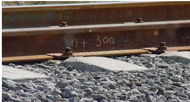
ACCESORIOS DE FIJACION EN UNA VIA ELASTICA
