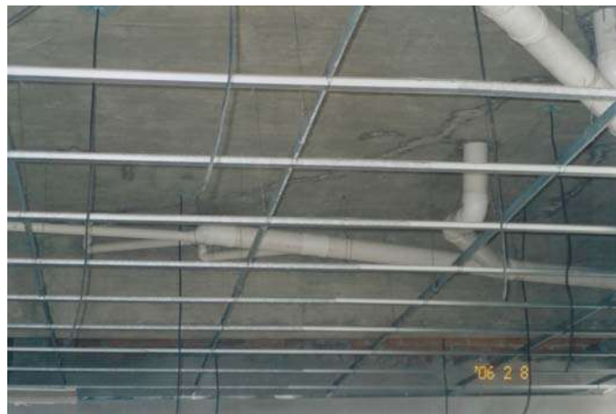
Instalación sanitaria entre falso plafón y losa.
