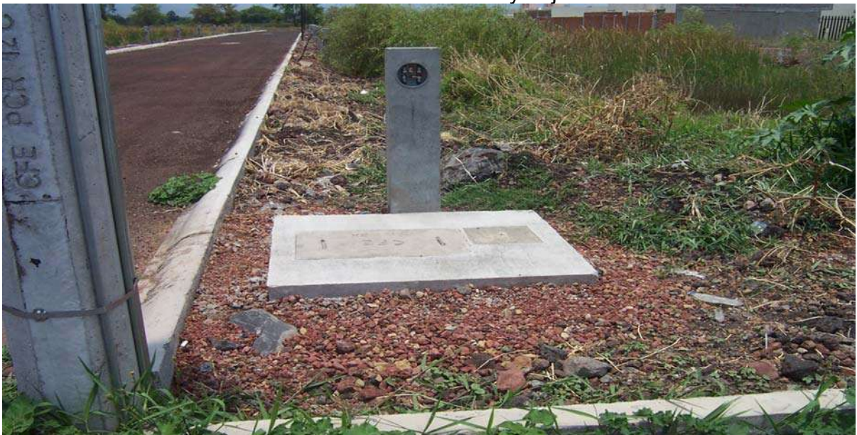
Registros eléctricos y paletas de medición
