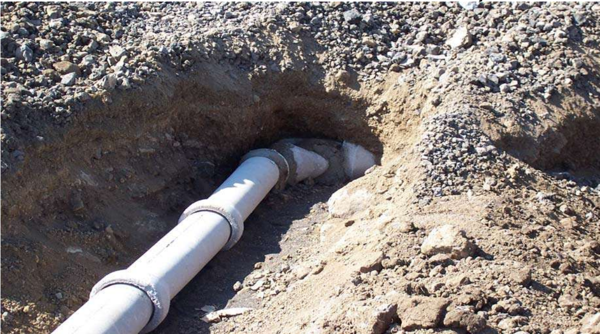
Codo y sland en descarga domiciliaria
