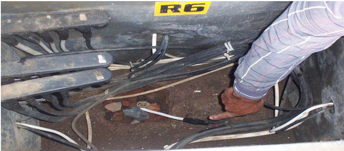
Conexiones de la red de media y baja tensión.
