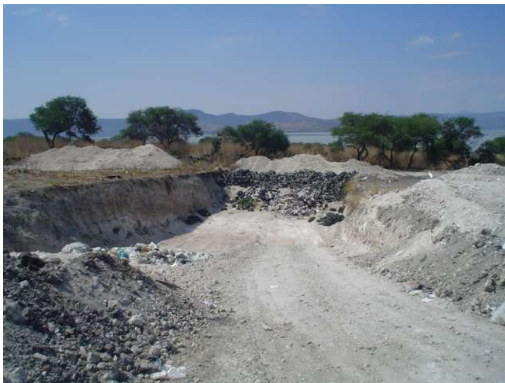
APERTURA DE CELDAS NUEVAS
