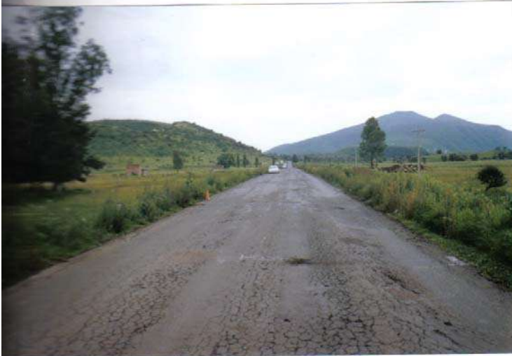
Figura 6.- Tramo antes de Reparar.
