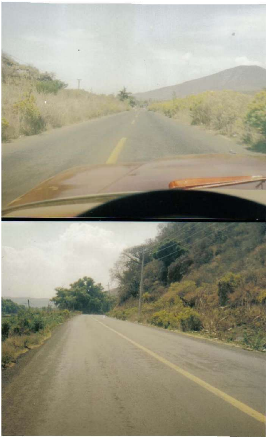
Figura 50.- Tramo Carretero Zacapu-Villa Jiménez Estaciones 10+500 y 11+700 3 años después de su construcción.
