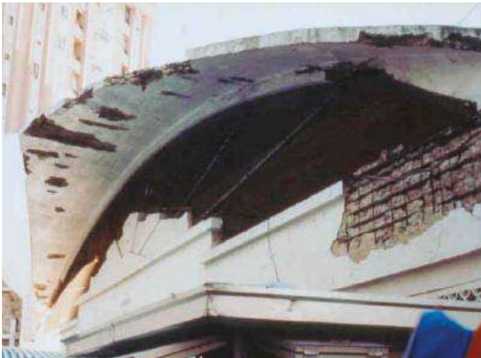
Figura 4.2. Estructura dañada por el fenómeno de Corrosión.
