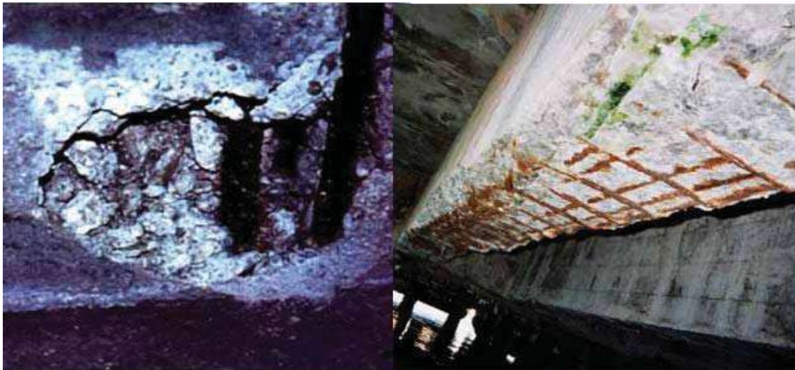
Fotografía 2.3. Efectos de la Corrosión. 1
