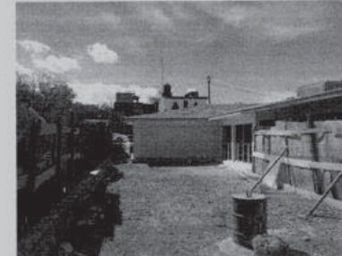
Imagen 35.- Vista Exterior Lateral de la Ampliación; se presenta el área del jardín, de cuya partida no se ejecutó ningún concepto. De la ampliación se aprecia la cancelería de la Sala de Espera en pésimas condiciones de fijado faltando los perfiles superiores. No se encuentran colocados los cristales, así mismo, se presenta el enladrillado de la losa.
