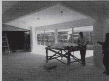
Imagen 30.- Muro lateral de Sala de Espera; se presenta la cancelería en pésimas condiciones de fijado faltando los perfiles superiores. No se encuentran colocados los cristales. En la losa se aprecian las salidas y el cableado de la instalación Eléctrica-Alumbrado faltando el suministro y la colocación de las tapas y las luminarias.
