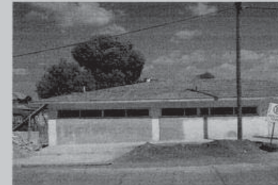
Imagen 36.- Vista Exterior de la Ampliación; vista desde la calle principal hacia el Consultorio de Ginecología y CARA. Se presenta la falta de limpieza en la misma así como el escombros y materiales sobrantes que no han retirado de la obra y están obstruyendo la vialidad de la calle. Se aprecia el enladrillado de la losa faltando el impermeabilizado y la ejecución correcta de las salidas de los tubos ventiladores.
