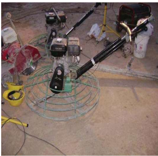
Fot. 59 ventilador (zancudo)
