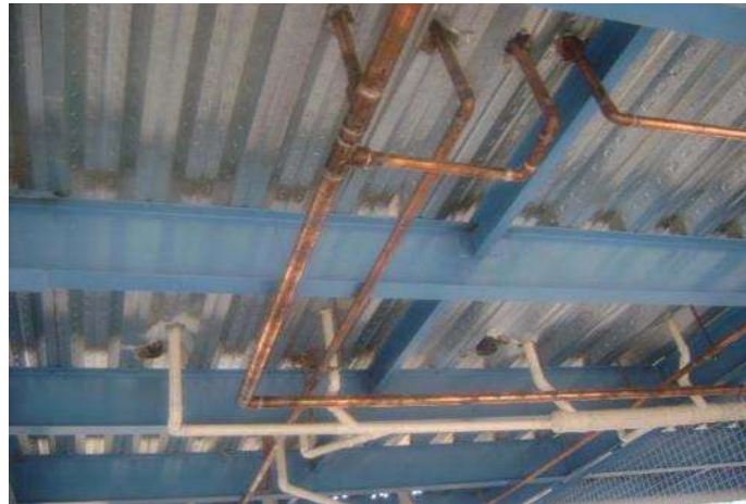
Fot. 66 Muestra parte de la instalación hidráulica y sus partes.
