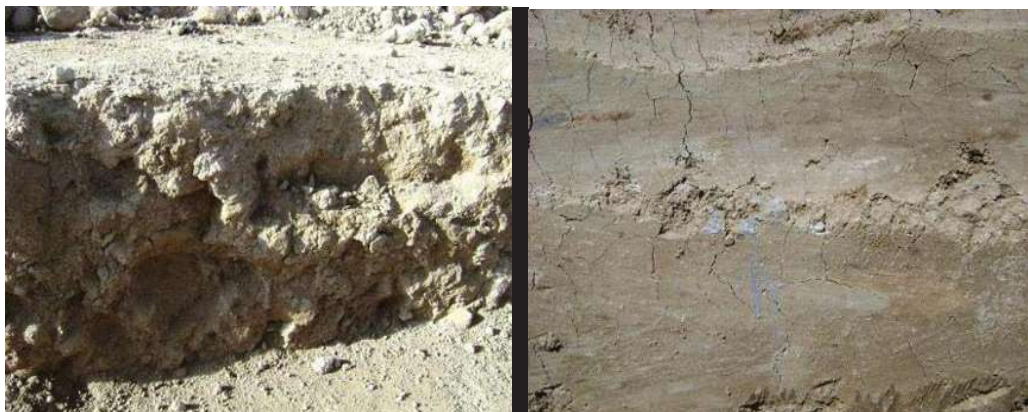
Fot. 12 Terreno mal compactado
