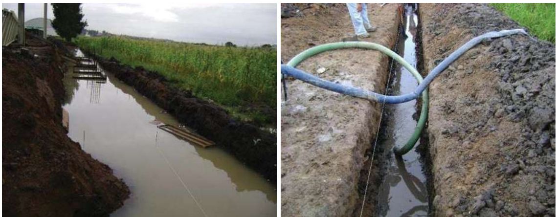
Fot. 18 y 19 Ejemplos de problemas de agua que se pueden presentar en algunas zonas de construcción.
