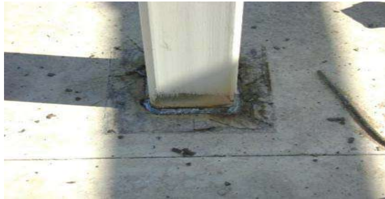
Fot. 81 Soldadura en la unión de una placa ahogada y una columna del masanini.
