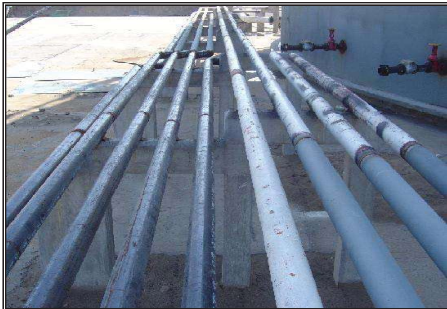
Fig. 8.8.- Líneas de cámaras de espuma.
