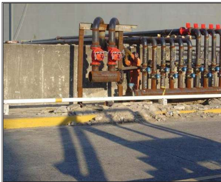
Fig. 8.2.- Cabezal de tubería para líneas contraincendio.
