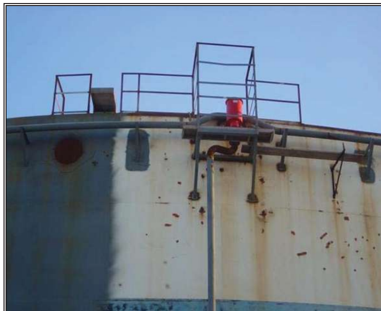
Fig. 8.7.- Plataforma y cámara de espuma instaladas.
