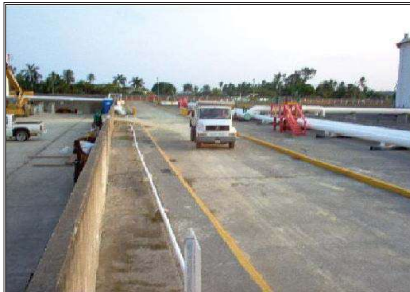
Fig. 3.1.- Ventana en dique para acceso de materiales y equipo.
