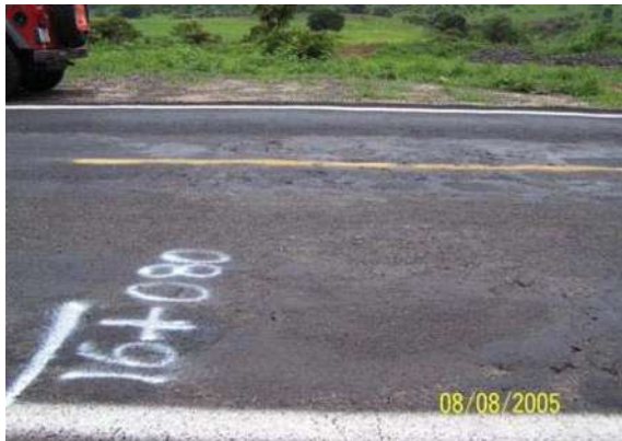
Km 16+080 existen principios de bache y protuberancias.
