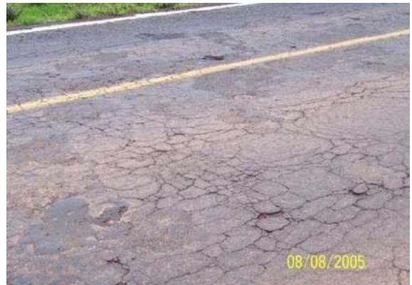
En algunos tramos muy deteriorados debido a que hay mucha pérdida de agregados lo que provoca el desprendimiento de la carpeta asfáltica.
