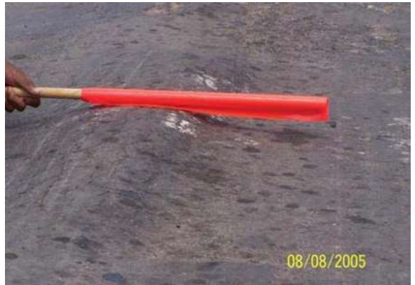
deformaciones longitudinales que le dan inestabilidad Al camino.
