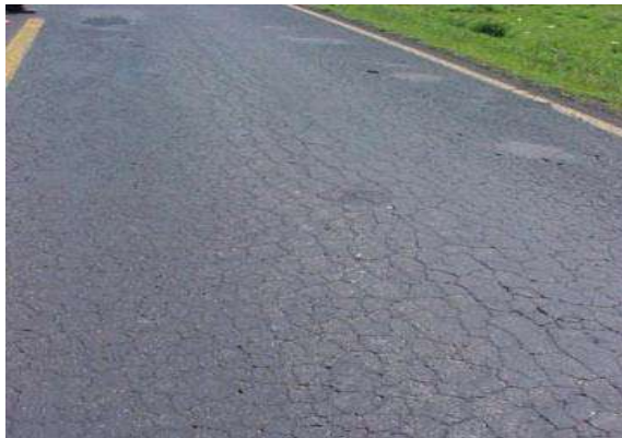
Grietas tipo mapa o mapeo, en donde se combina Deformaciones longitudinales y una superficie lisa
