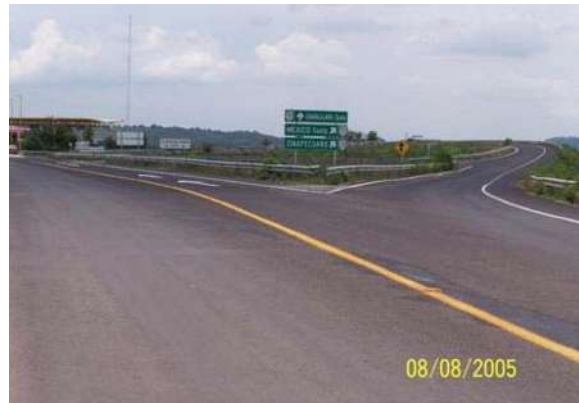
Al inicio del tramo se encuentra en buenas condiciones ya que cerca se encuentra la autopista.
