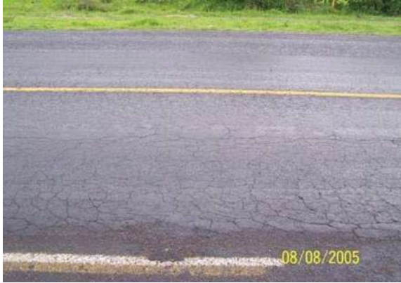
Agrietamiento tipo piel de cocodrilo característico En lo largo del todo el tramo en estudio.
