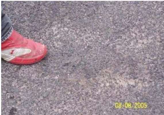
Perdidas de los agregados fino en algunas zonas De la carretera.
