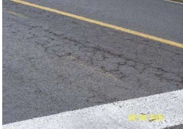
calavereo sobre la superficie se observa en pequeñas Franjas a lo largo del tramo.
