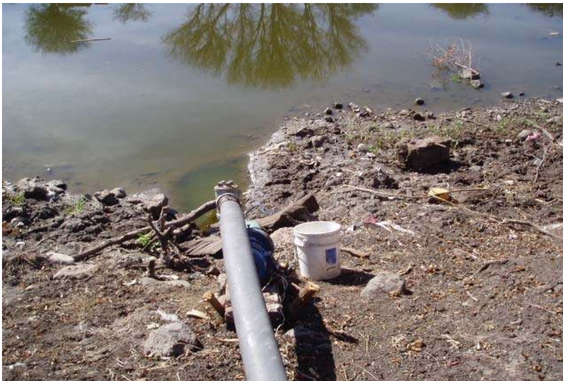
MODULO DE RIEGO II LA PIEDAD BOMBEO SOBRE EL RIO LERMA
