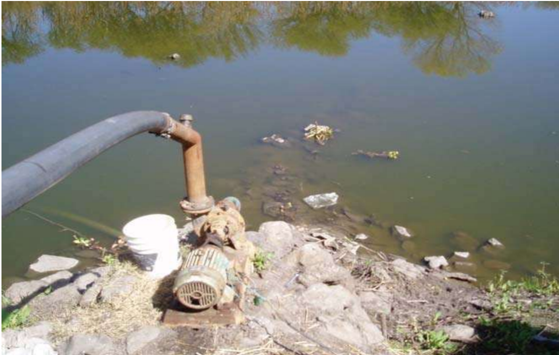
MODULO DE RIEGO II LA PIEDAD BOMBEO SOBRE EL RIO LERMA
