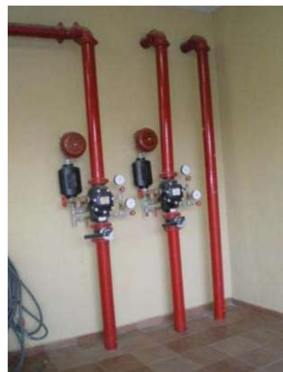
Cuadro de válvulas y ductos
