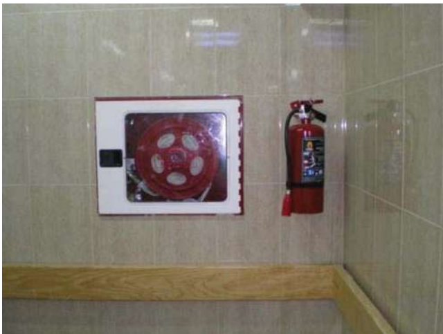
Hidrante y extintor
