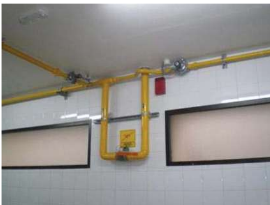
Ductos de gas.
