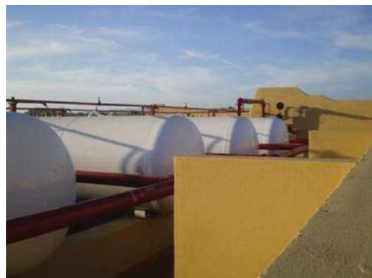
Tanques de gas.
