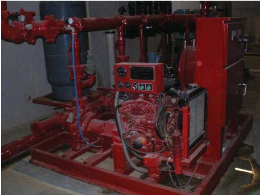
Equipo contra incendio, bomba diesel, eléctrica y jockey.
