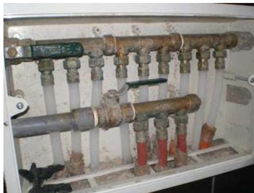
Colector de latón y manguera de polietileno en columnas del sistema barbi.
