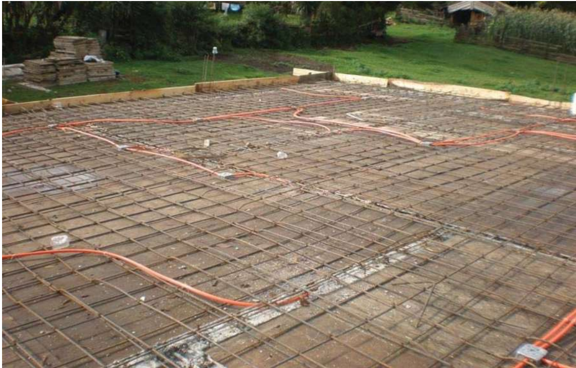
FOTO No. 3 (INSTALACIÓN ELECTRICA).
