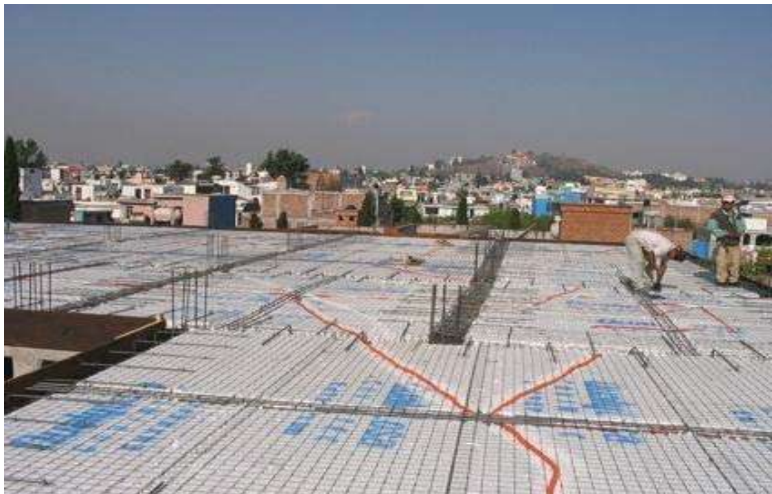
FOTO No. 18 (INSTALACIÓN ELECTRICA).
