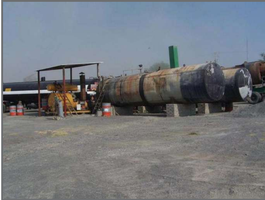
Figura 4.2 Tanques de almacenamiento del asfalto
