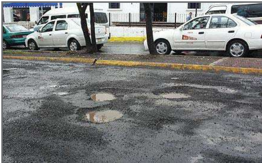
Figura 2.8 Tramo de la avenida camelinas al finalizar la temporada de lluvias, un problema que se presenta incluso en avenidas principales de nuestra ciudad
