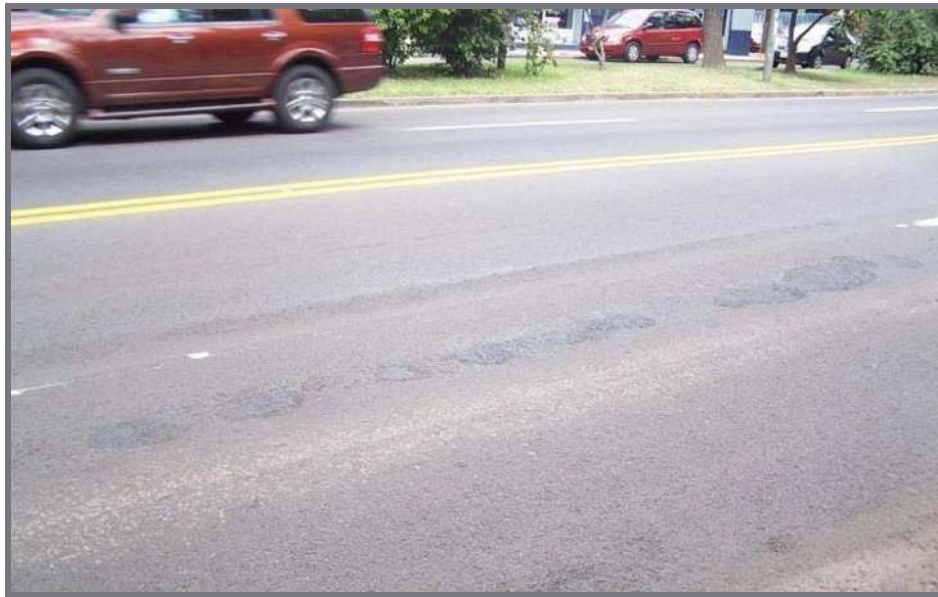
Figura 2.7 Tramo bacheado de la avenida camelinas como consecuencia del desprendimiento de agregado pétreo en la carpeta
