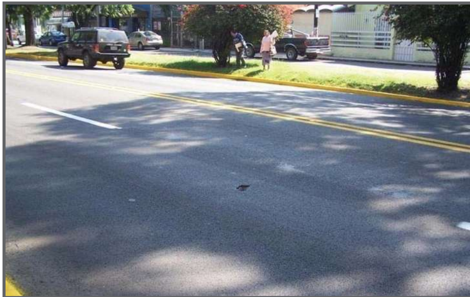
Figura 2.6 Tramo de la avenida camelinas donde se observa desprendimiento de material pétreo al poco tiempo de haber terminado su rehabilitación.
