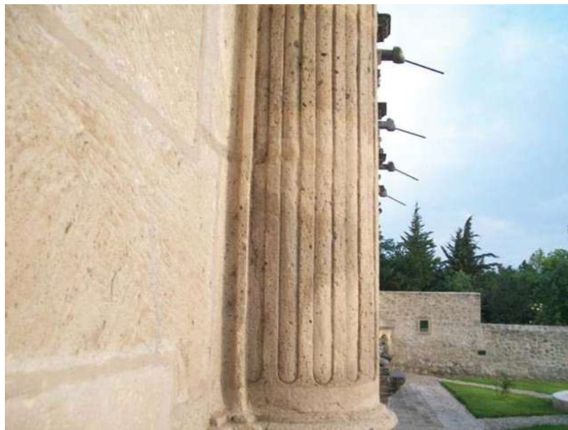
Figuras39 (arriba) y 39-B (sobre estas líneas) La parte blanca de la figura 39 muestra zonas más calientes debido a la delaminación que sufre el fuste. Fotografías: autor
