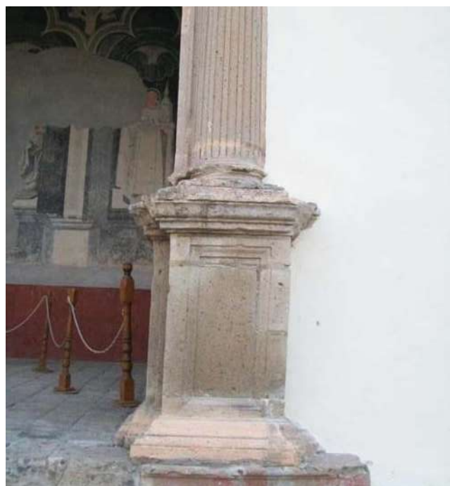
Figuras 37 (arriba izquierda), 37-A (arriba derecha) y 37-B (sobre estas líneas) Nótese en la fig. 37 y 37-B que aparentemente se trata de un pedestal sano, pero observando la fig. 37-B se muestran cambios de temperatura perfectamente visibles cuya posible causa es la delaminación existente en los elementos del elemento arquitectónico. Fotografías: autor
