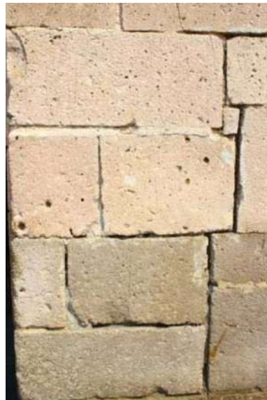
Figuras 36 (arriba izquierda), 36-A (arriba derecha) y 36-B (sobre estas líneas) En las FI puede observarse la mayor emisividad térmica en la parte baja del muro. Obsérvese en la FD el cambio de color entre una ignimbrita y otra. FI: Autor; FD: Jocelyn Alvarez A.
