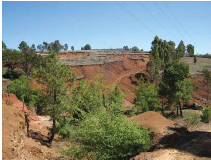
Foto 3.4 Zona erosionada (cárcavas).
