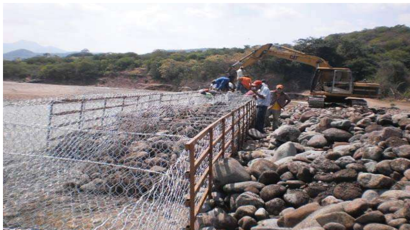
III.2.8.3.6.- Imagen 20.- Piedra para la formación de Gaviones
