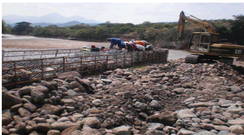
III.2.8.3.6.- Imagen 21.- Piedra para la formación de Gaviones
