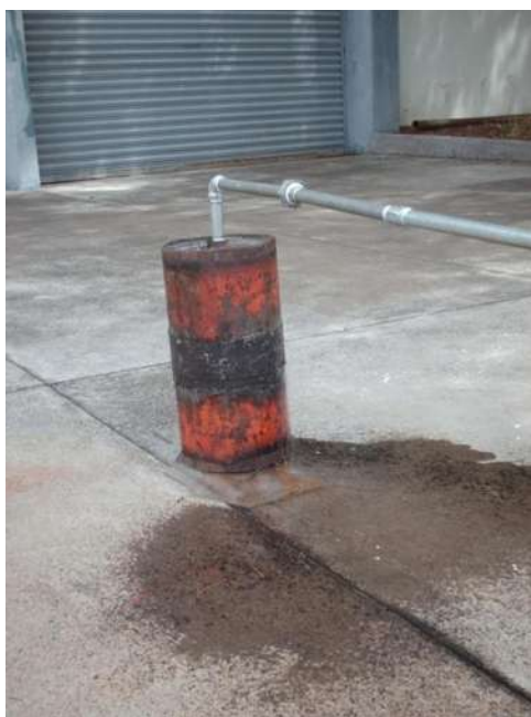
Figura 5.1.- Falla de la primera prueba, fuga de agua a una presión de trabajo baja
