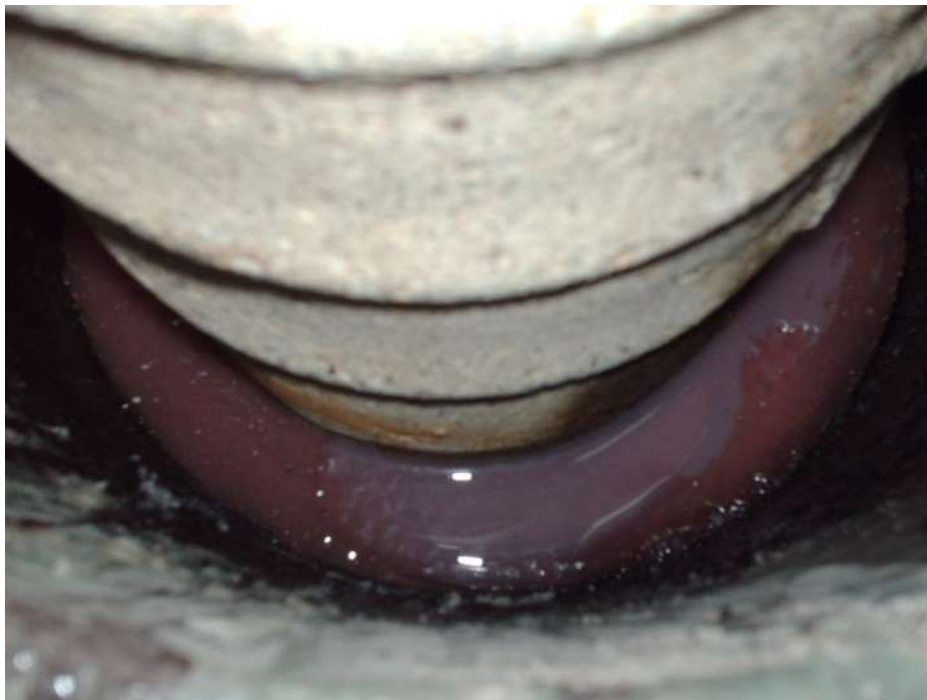
Figura 3.32- Percolación de agua en la Tubería de concreto sin composite
