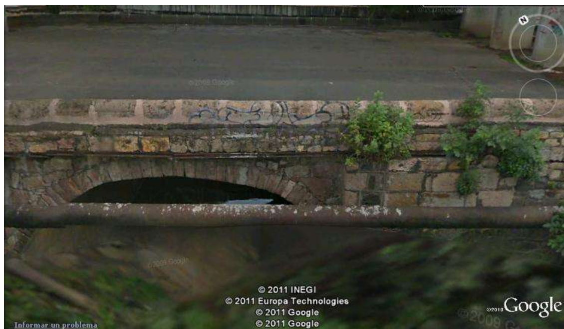
Figura 2.16.- Tubería de la línea sur (tramo a intemperie). [24]
