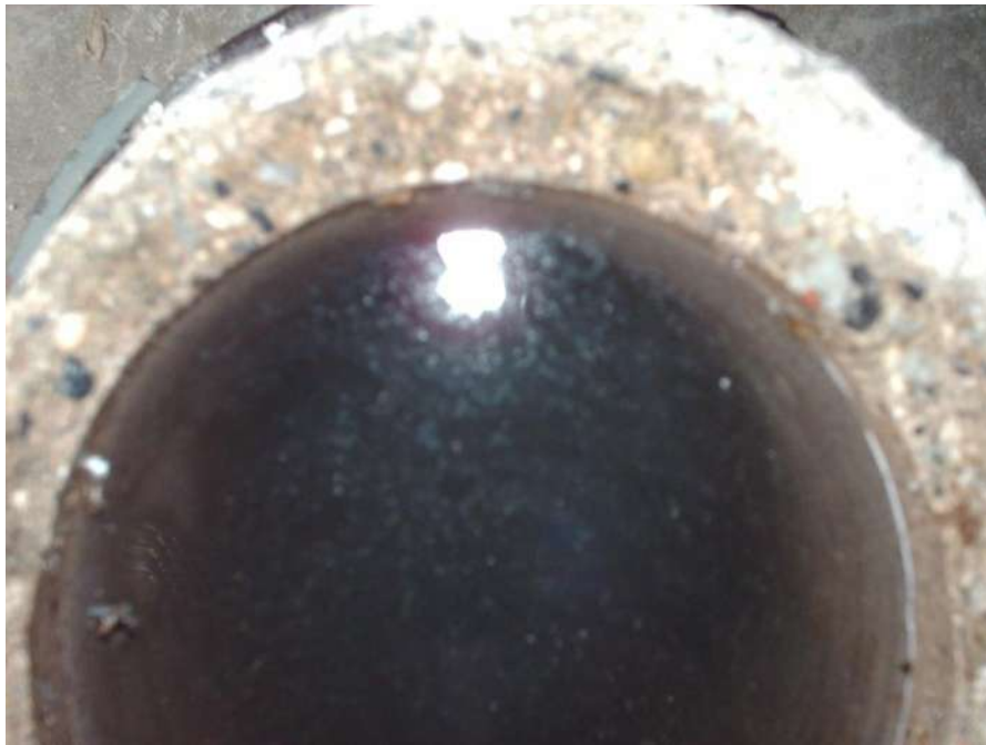
Figura 3.31- Tubería de concreto sin composite (lleno de agua)
