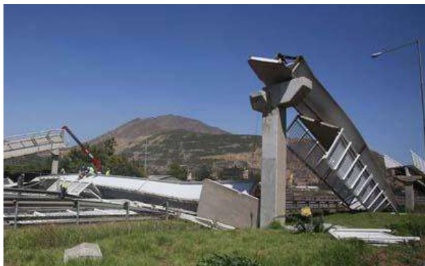
Figura 11 – Puente colapsado por el terremoto de 8.8 grados en Chile.
