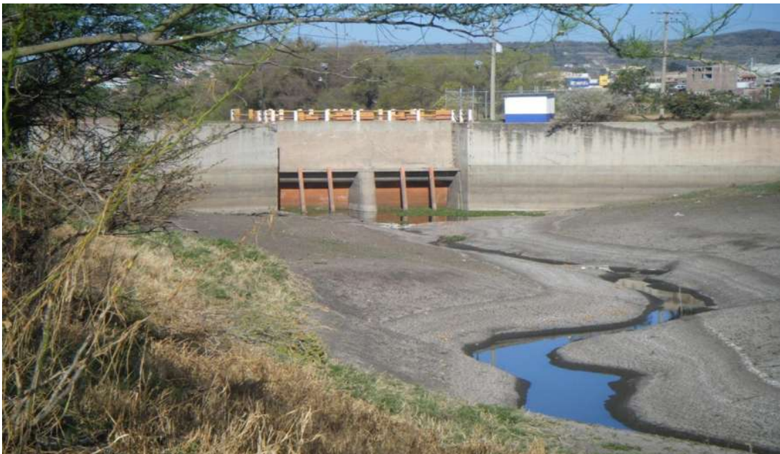
Figura 5-26 Compuerta de entrada
