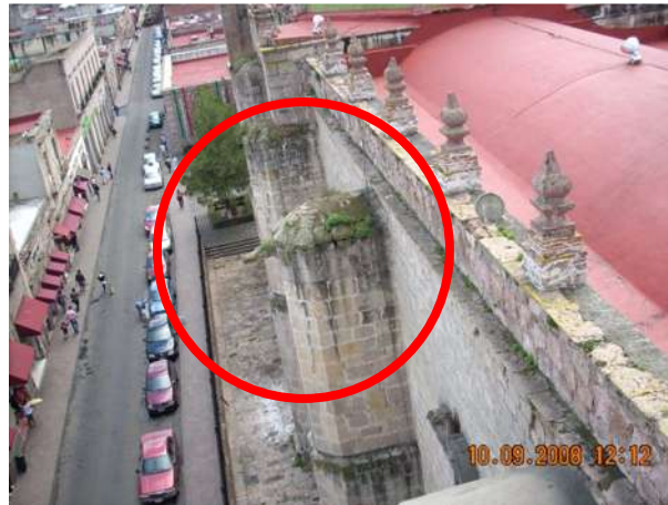
Figura 37 Presencia de vegetación (O. Segura, 2008).
