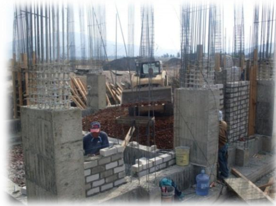
Fig. 3.18. Levantamiento de los enraques de tabicón en el edificio de aulas.
