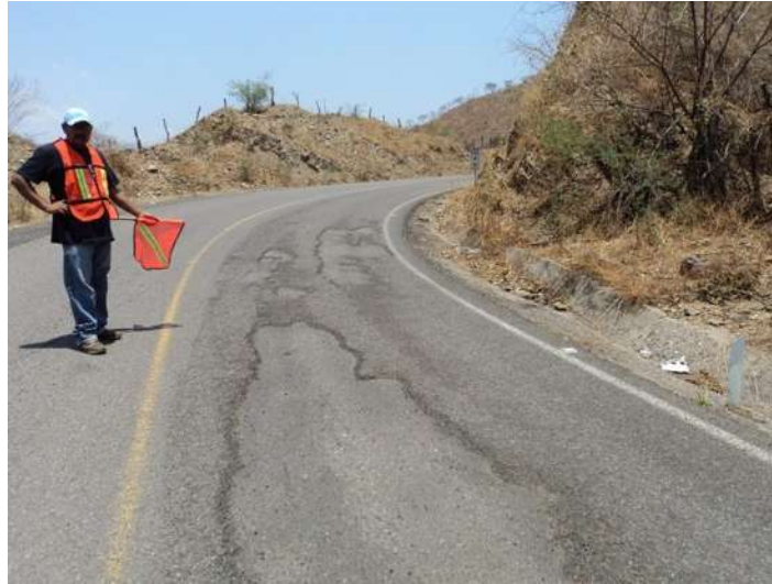
Imagen: V.VI.I. De desprendimiento
