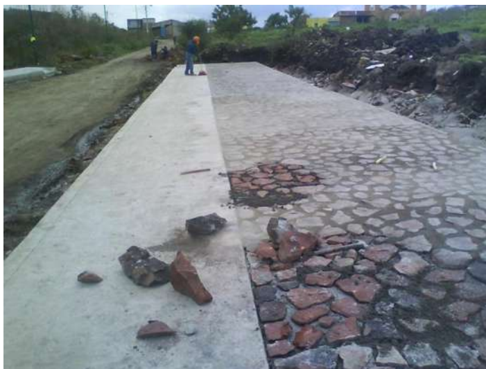
FOT 5.17: BANQUETA Y EMPEDRADO AHOGADO EN CONCRETO
