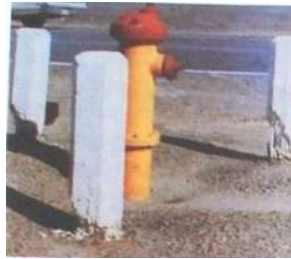
Ilustración 23. El ataque de sulfatos es frecuentemente más severo en la región sometida a mojado y secado, la cual es, normalmente, cerca del nivel del suelo. Aquí los postes han sido atacados por sulfatos cerca del nivel del suelo.
