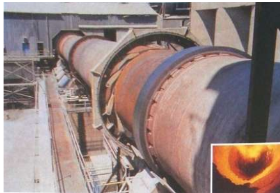
Ilustración 4. Horno rotatorio para la manufactura del clínker de cemento. La foto, menor, abajo y a la derecha trae una vista interior del horno.
