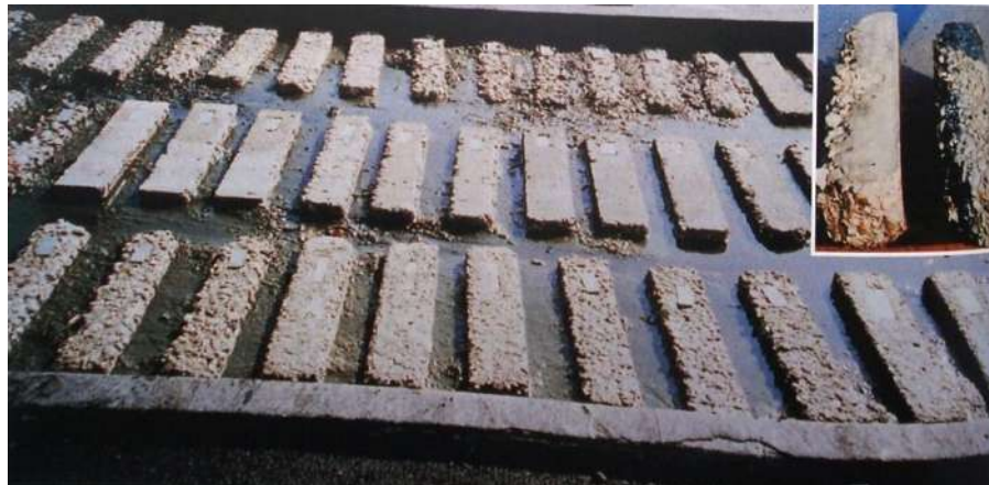
Ilustración 24. Vigas de concreto después de muchos años de exposición a un suelo con alta concentración de sulfatos en Sacramento, California, terreno de ensayo. Las vigas en mejores condiciones tienen bajas relaciones agua-materiales cementantes y muchas de ellas tienen cemento resistente a los sulfatos. La foto menor, a la derecha en la
