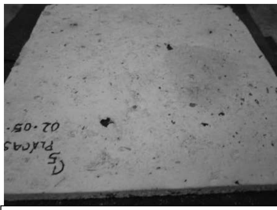
Imagen 5.50. Se presenta pequeña mancha en placa por retener agua superficial [propia].
