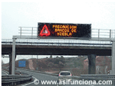
Figura 2.20.6. Panel informativo compuesto por diodos LEDs, situado en una carretera para avisar en esta ocasión a los conductores la existencia de bancos de niebla [76].
