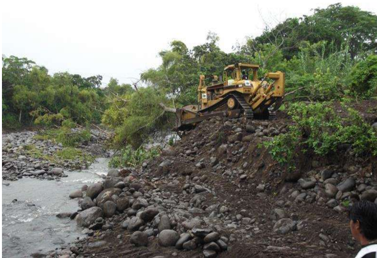
Imagen III.4 Desmonte en la zona donde se extraerá el material para el pedraplén Y formara el encausamiento en el km 0+000 al km 0+360.
