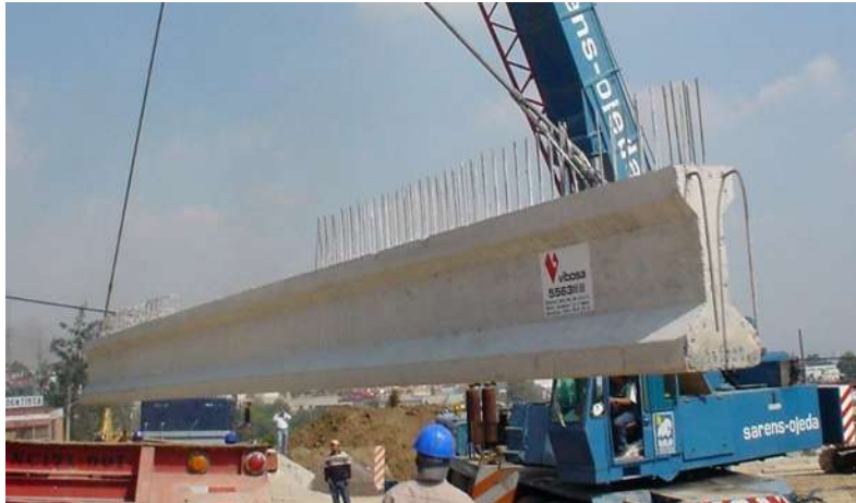
Figura 1.6 - Trabe AASHTO pretensada [VIBOSA S.A. de C.V.]
