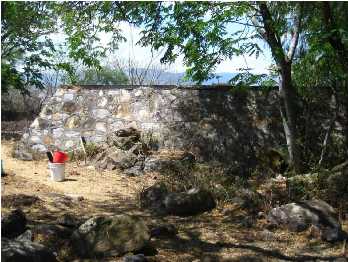
Figura 4.15. Tanque superficial de mampostería con capacidad de 115.2m 3
