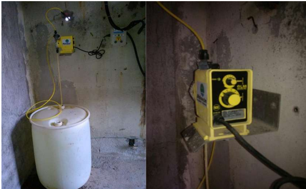
Figura 4.3 y 4.4. Equipos utilizados para la cloración del agua en el pozo no. 1
