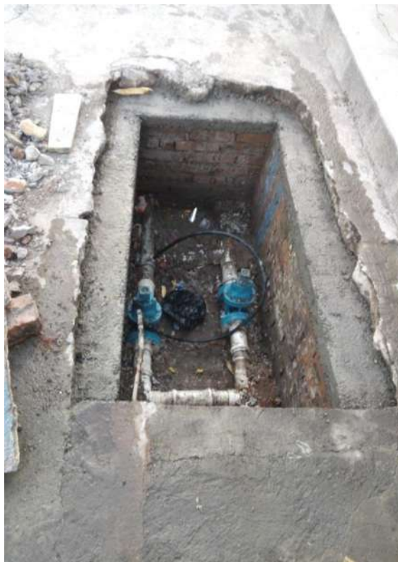
Figura 4.28. Principal crucero de la línea de alimentación del tanque No. 2
