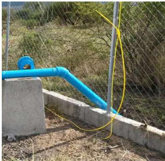
Figura 4.14. Tubo de fierro fundido (Fo. Fo.) de 4 pulgadas, cédula 14
