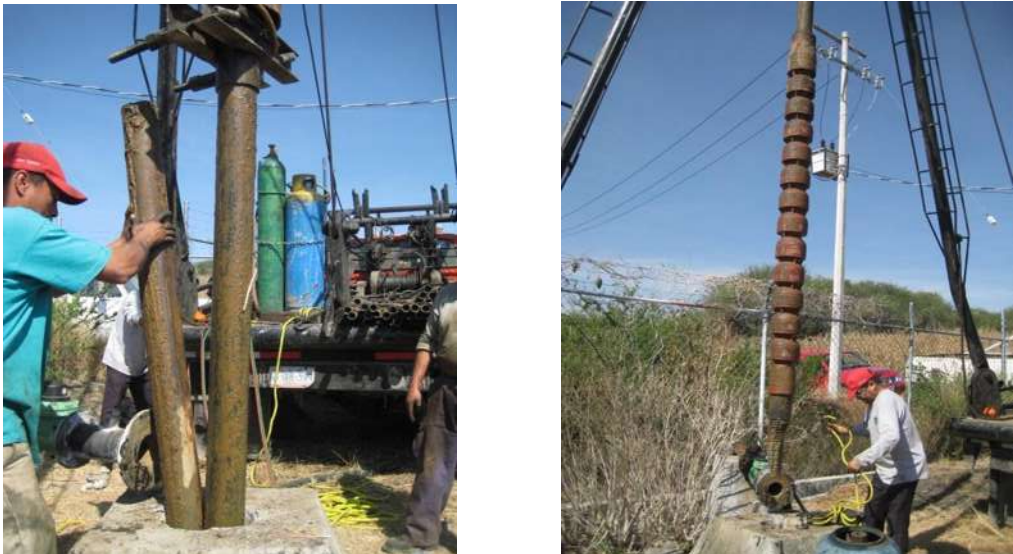
Figuras 6.4 y 6.5. Problemas de caída de flecha en el pozo No. 2
