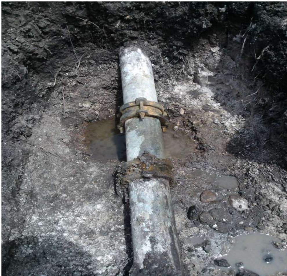
Figura 4.13. Tubo de fibrocemento de 6 plg, cedula 14
