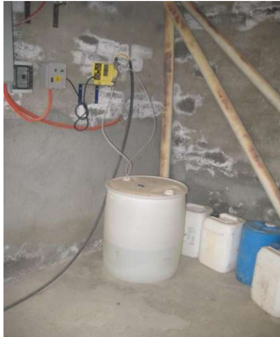
Figura 4.5. Sistema de cloración utilizado en el pozo No. 2
