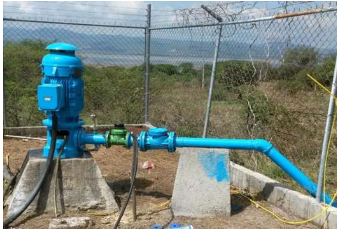
Figura 4.8. Tren de descarga pozo No. 2
