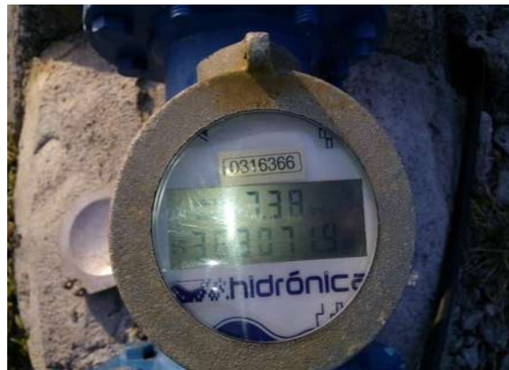
Figura 4.7 Medidor de flujo
