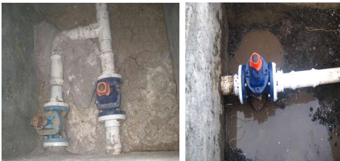
Figura 4.25 y 4.26. Desagüe del tanque y válvula alimentadora
