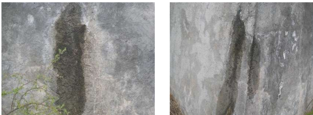
Figura 4.21 y 4.22. Problemas de filtración del agua por las paredes del tanque
