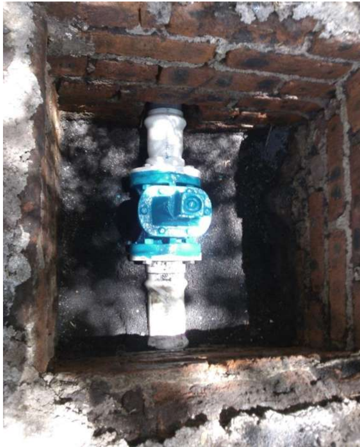
Figura 4.27. Línea de alimentación al primer crucero
