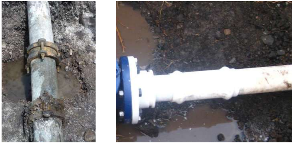
Figuras 6.8 y 6.9. Tipos de tubería usados en la línea de conducción.
