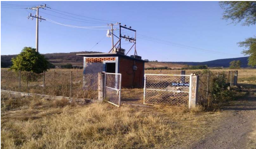
Figura 4.1. Instalaciones del pozo profundo No. 1
