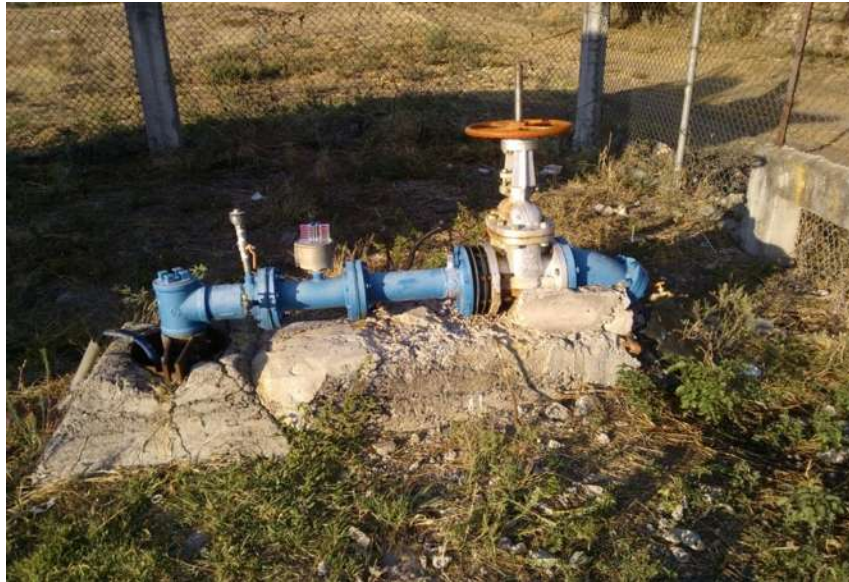
Figura 4.6.- Tren de descarga del pozo No. 1
