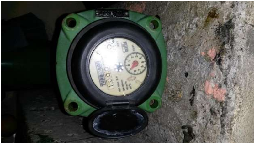
Figura 6.7. Medidor de flujo del Pozo No. 2
