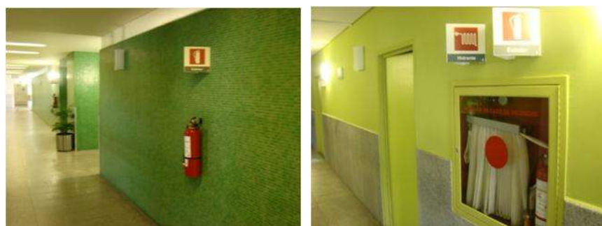
Figura 3.35 Extintores e hidrantes del HGR N° 1
