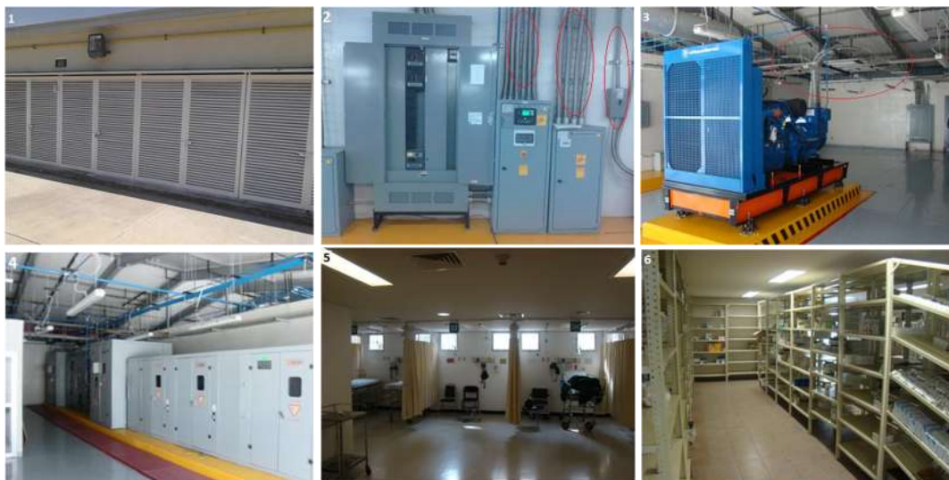
Figura 3.53 Sistema eléctrico del HGZ N° 83
