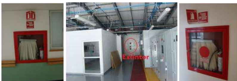
Figura 3.60 Extintores e hidrantes H.G.Z. N° 83
