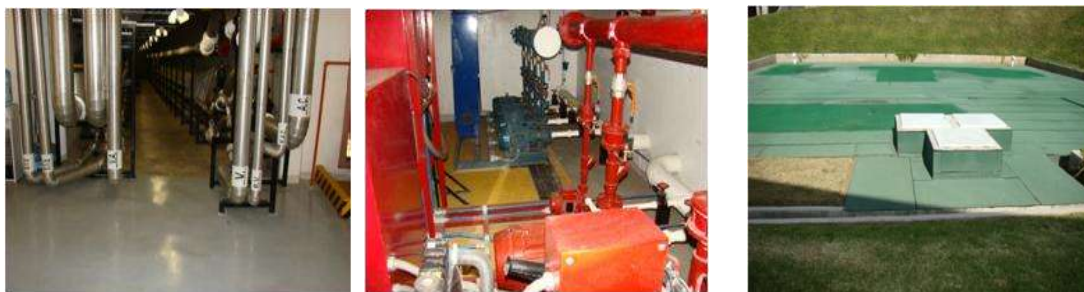
Figura 3.30 Cisterna del H.G.R. N° 1
