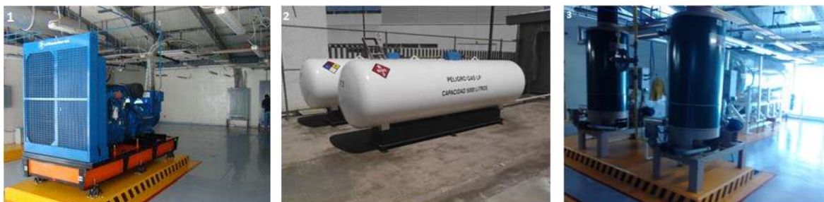
Figura 3.56 Depósito de combustible del HGZ N° 83
