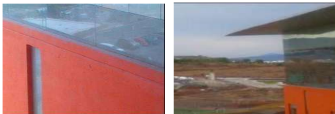
Figura 3.14 Archivo fotográfico de daños por sismo del HGR N° 1
