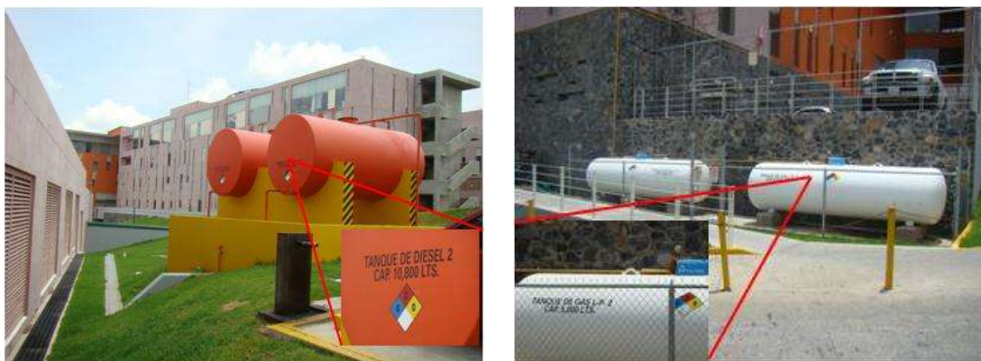
Figura 3.31 Deposito de gas y diesel del H.G.R. N° 1
