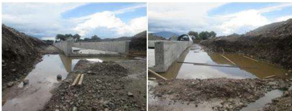
Figura 3.2.2.- Daños por precipitación.
