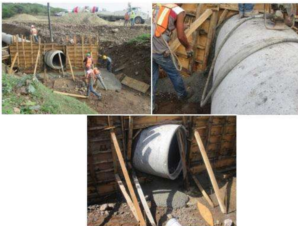
Figura 2.9.- Falla de la cimbra.
