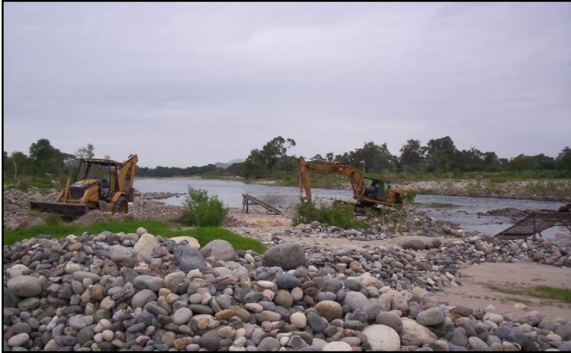
Fotografía 6.- Zona de cribas y almacén del banco Flamingos.
