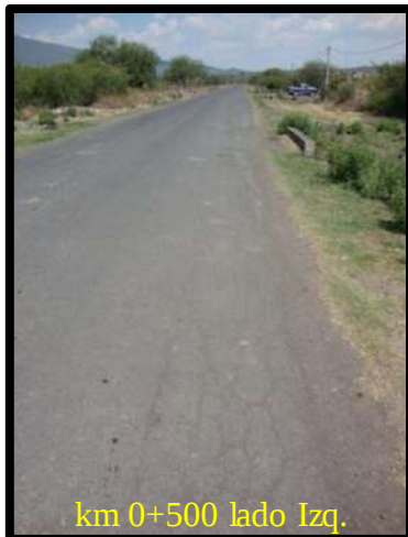
Foto 3. Se muestra una alcantarilla en el km 0+500 con maleza.
