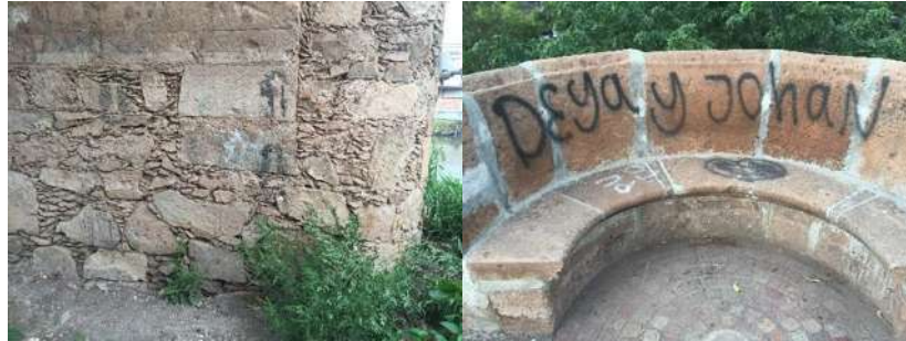
Ilustración 189. Caballetes y Contrafuertes semicirculares con daños antrópicos. (GARCÍA CHÁVEZ, 2016)
