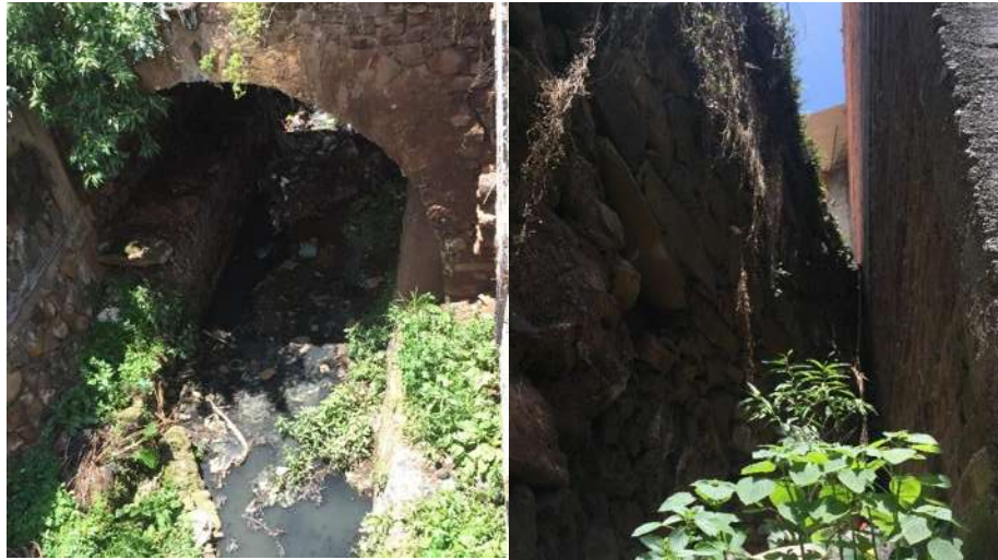
Ilustración 153. Casas aledañas construidas al pie de los estribos del puente, así como el inviable acceso al pie del puente. (GARCÍA CHÁVEZ, 2016)
