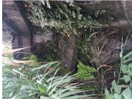
Ilustración 197. Exceso de vegetación en la zona sur Poniente del puente. Imposible el acceso. (GARCÍA CHÁVEZ, 2016)
