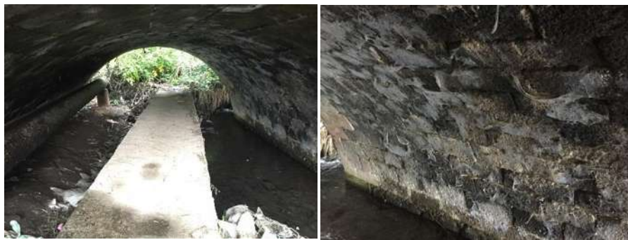
Ilustración 208. Intradós de los arcos contaminados con telarañas, presencia de costras, deterioro diferencial, alveolos, exfoliación, criptoflorescencias y desprendimiento de las canteras. (GARCÍA CHÁVEZ, 2016)
