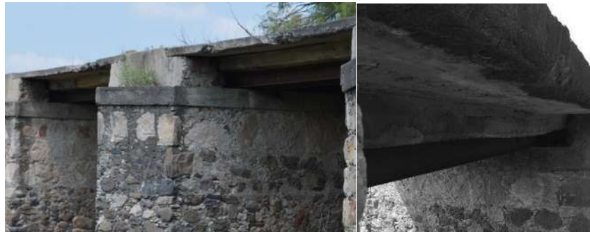
Ilustración 226. A la izquierda. Deformaciones en la calzada debido a las cargas de los vehículos. A la derecha. Fisuras y exfoliación de la parte inferior de la calzada del Puente. (GARCÍA CHÁVEZ, 2016)
