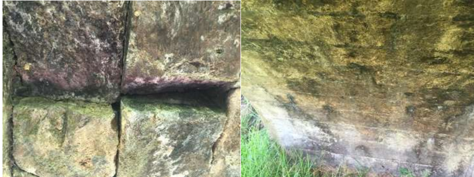
Ilustración 173. Coloración, humedad y desprendimiento granular. (GARCÍA CHÁVEZ, 2016)
