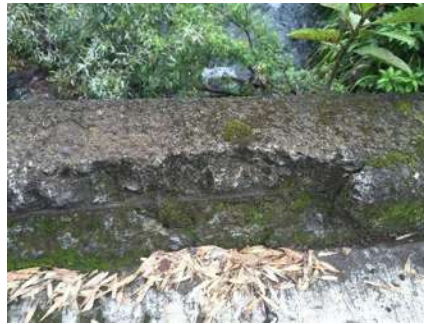
Ilustración 205. Desmoronamiento de los bordes de la calzada. (GARCÍA CHÁVEZ, 2016)
