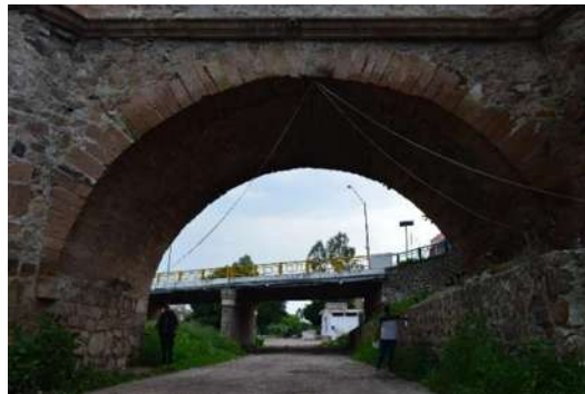
Ilustración 185. Gavión al pie del estribo del Puente. (GARCÍA CHÁVEZ, 2016)
