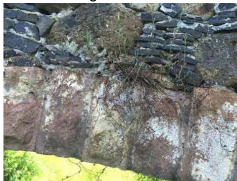
Ilustración 170. Presencia de vegetación en el pretil del puente. (GARCÍA CHÁVEZ, 2016)
