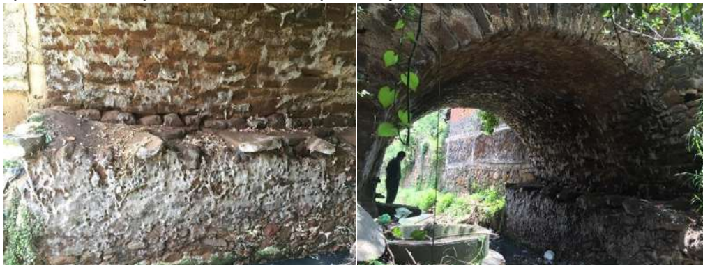
Ilustración 161. Manchas de humedad y Telarañas en el Gavión y en el Intradós del arco del Puente. (GARCÍA CHÁVEZ, 2016)
