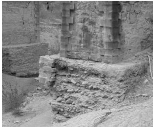
Ilustración 71. Ejemplo de deterioro del elemento estructural zapata de un puente de fábrica. (Martínez, MARTín-Caro, & León, 2003, pág. 60)
