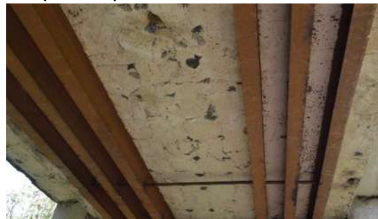
Ilustración 225. Vigas corroídas debido a la exposición a la intemperie. (GARCÍA CHÁVEZ, 2016)
