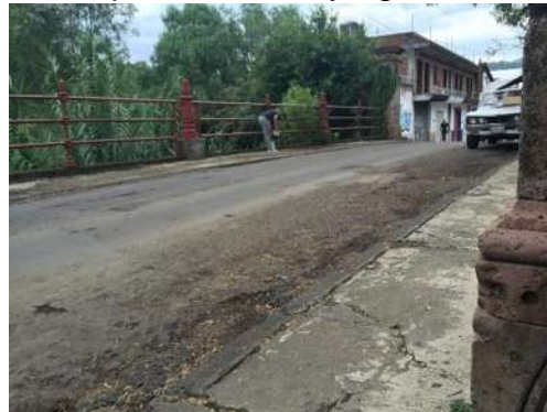
Ilustración 203. Calzada del Puente con agrietamientos y desprendimientos de la carpeta asfáltica. (GARCÍA CHÁVEZ, 2016)
