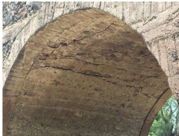
Ilustración 142. Fracturas en el intradós del arco. (GARCÍA CHÁVEZ, 2016)
