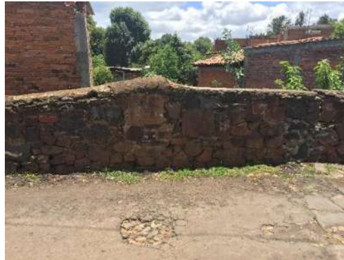
Ilustración 155. Signos de vegetación en la Calzada. (GARCÍA CHÁVEZ, 2016)
