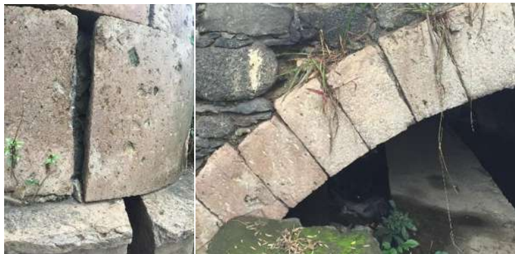
Ilustración 206. Pilastras y dovelas con problemas de adherencia. (GARCÍA CHÁVEZ, 2016)
