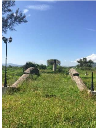
Ilustración 169. Vegetación en la calzada del puente. (GARCÍA CHÁVEZ, 2016)
