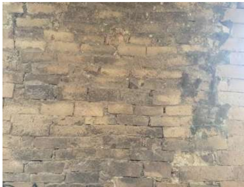
Ilustración 188. Pátinas, costras, arenización y fracturas en el intradós de los arcos del puente. (GARCÍA CHÁVEZ, 2016)
