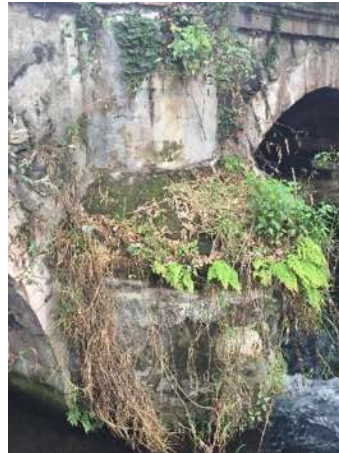
Ilustración 209. Tajamares con invasión de vegetación, desmoronamiento de material y eflorescencias. (GARCÍA CHÁVEZ, 2016)
