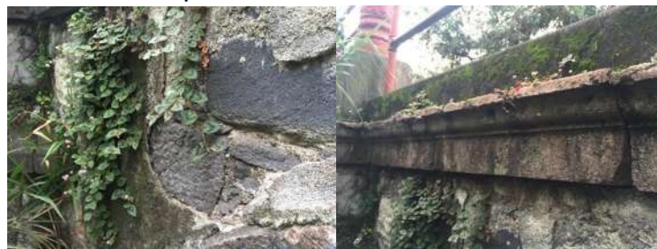
Ilustración 199. Musgo y desprendimiento de aplanado en el puente. (GARCÍA CHÁVEZ, 2016)
