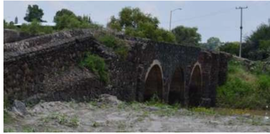
Ilustración 138. Vegetación en muros del pretil (GARCÍA CHÁVEZ, 2016)
