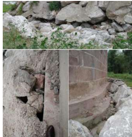
Ilustración 74. Arrastre y pérdida de elementos de protección. (Martínez, Martín-Caro, & León, 2003, pág. 61)
