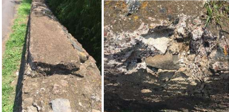
Ilustración 143. Desmoronamiento de la Corona del Puente. (GARCÍA CHÁVEZ, 2016)
