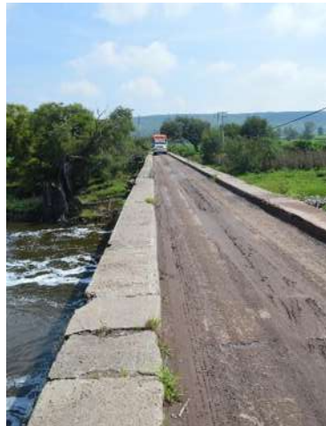
Ilustración 215. Condiciones de la calzada del puente. (GARCÍA CHÁVEZ, 2016)
