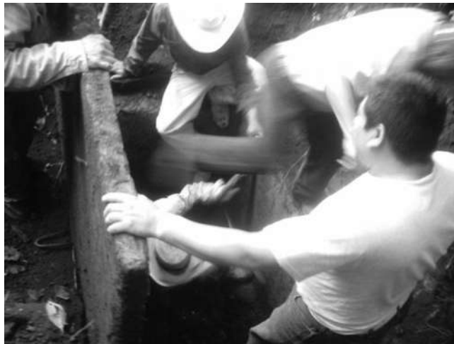
Figura 5. Mantenimiento del manantial “El Peral”
