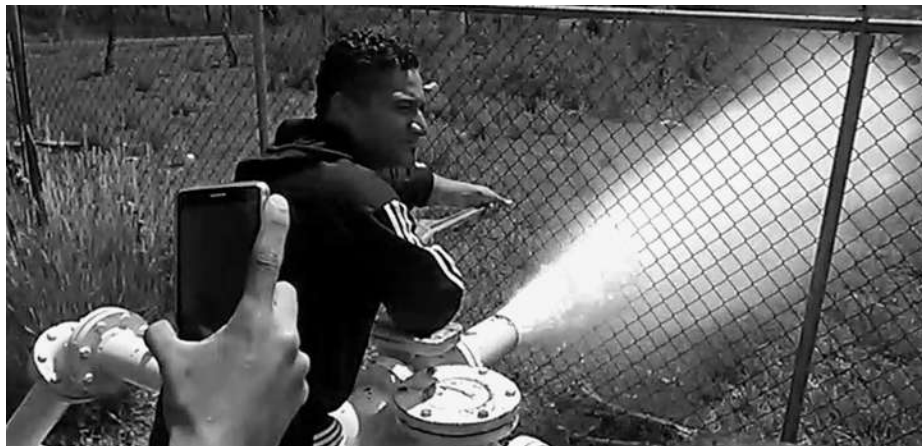
Figura 8. Purgado de bomba de extracción de agua
