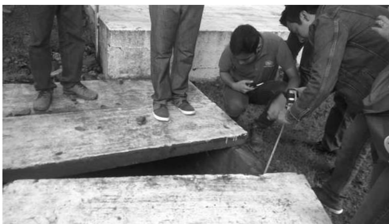
Figura 5. Tanque de captación del manantial “El Ojo de Agua”
