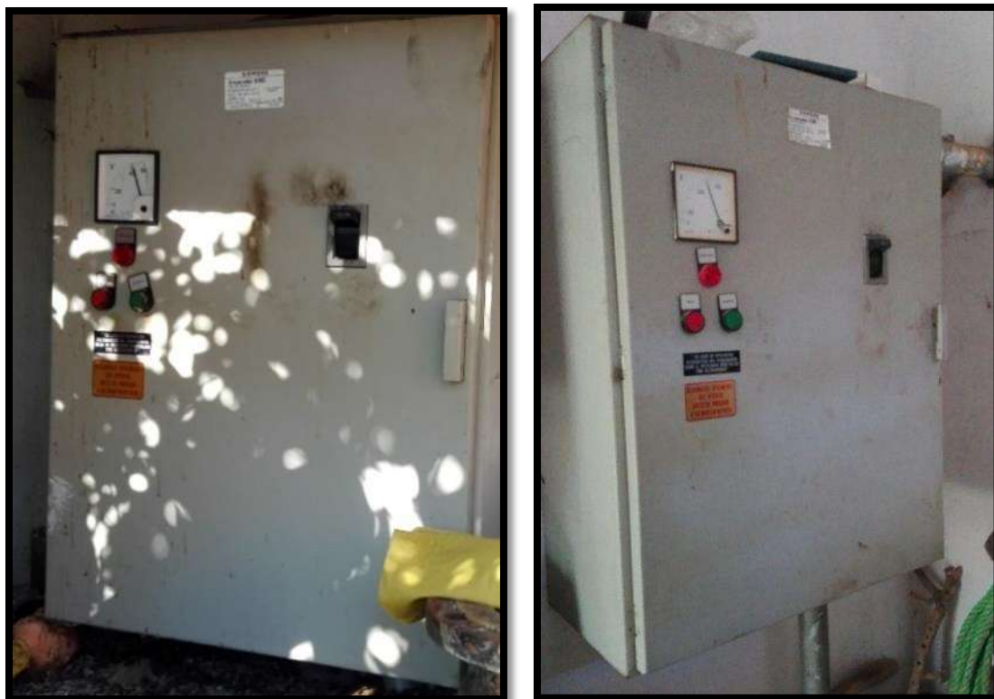
Figura 4.11 y 4.12. Tableros de control del pozo (izquierda) y rebombeo (derecha)
