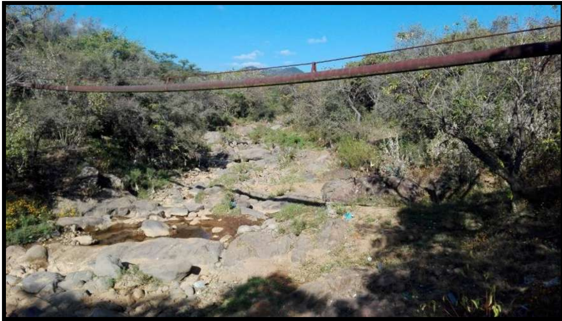
Figura 4.14. Tubo de fierro fundido de 6 plg,
