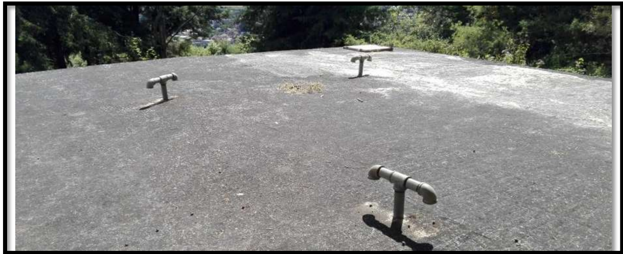
Figura 4.21 respiradores o tubos de ventilación
