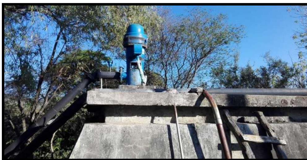
Figura 4.2 tanque superficial de rebombeo.
