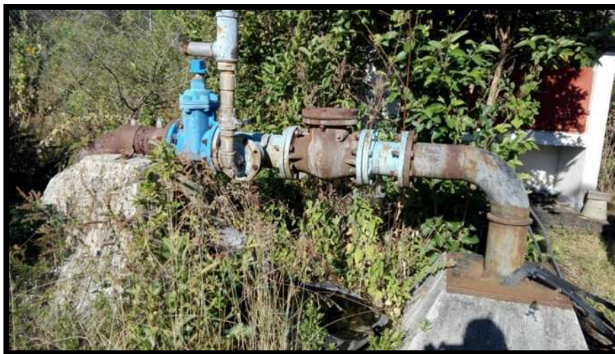
Figura 4.1. Instalaciones del pozo profundo
