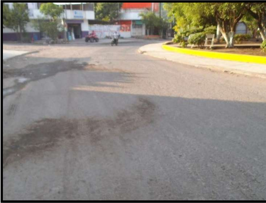
Deformaciones transversales, agrietamiento piel de cocodrilo, Perdida de agregado grueso. KM 1+500
