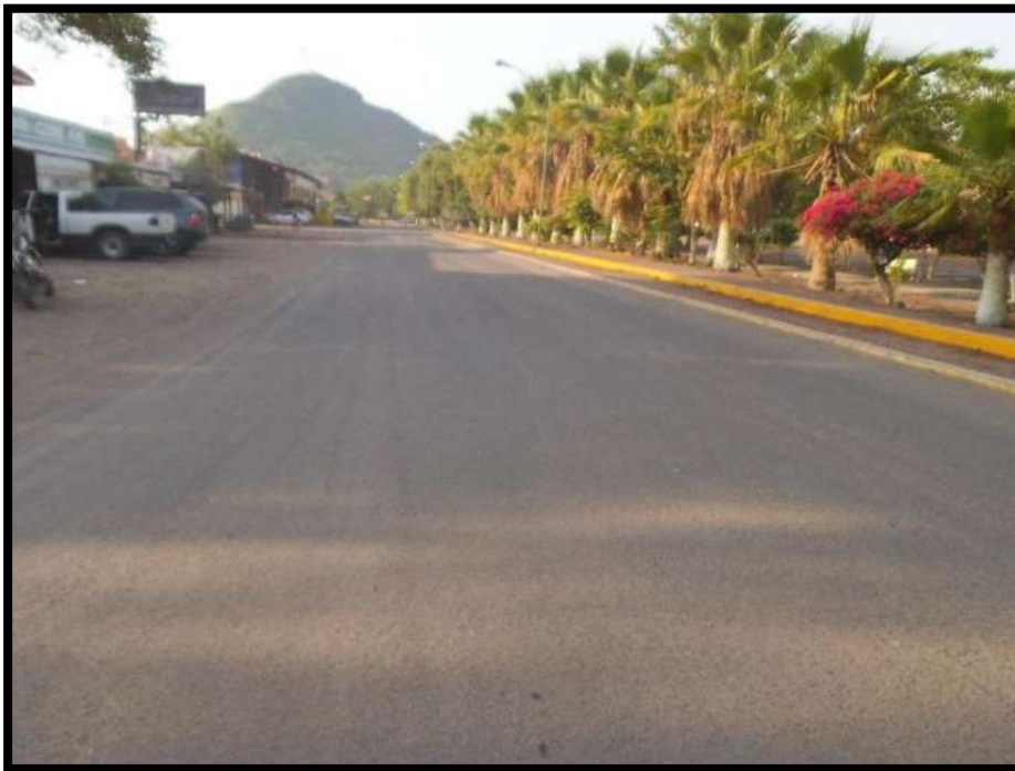
Agrietamiento ligero de mapa, pérdida de agregado fino. KM 1+800
