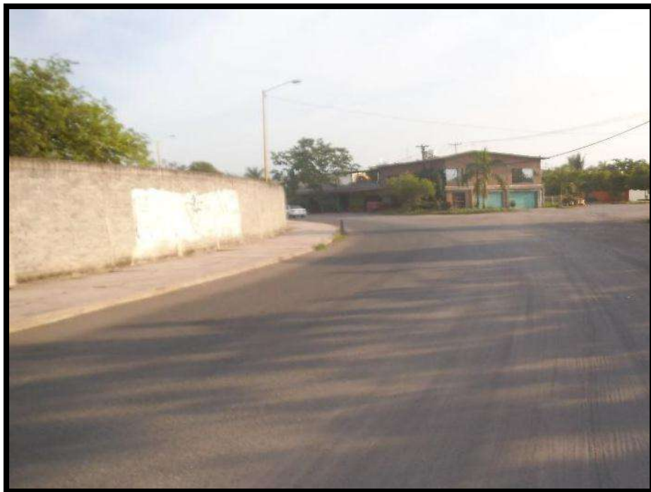
Agrietamiento ligero de mapa, perdida de agregado fino. KM 2+100 CUERPO DERECHO
