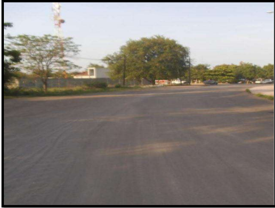
Agrietamiento ligero de mapa, perdida de agregado fino. KM 2+100
