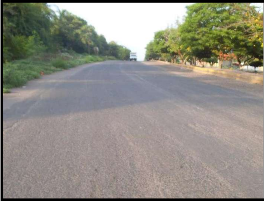
Pulimiento agregados, exudación de asfalto, calavereo ligero. KM 0+900
