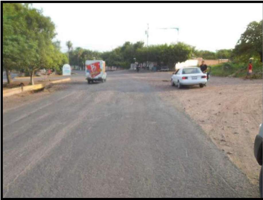
Agrietamiento piel de cocodrilo y agrietamiento.
